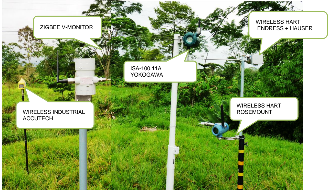
Figura 14: Instrumentos de transmisión inalámbrica instalados para el monitoreo de temperatura ambiente
