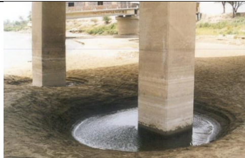
foto 7 Socavación presenciada en tiempo se sequia (Robie Bonilla, s.f.)
