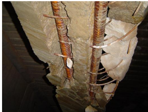
foto 18 Corrosión de ductos de cables de postensado (SIPUCOL, 1999)
