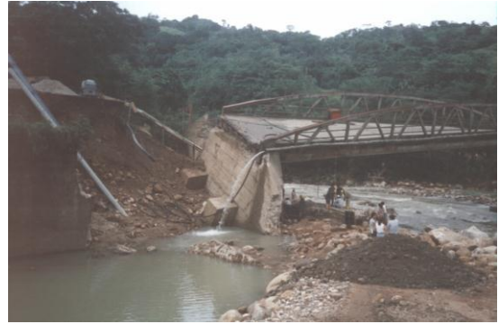
foto 2 Foto del colapso del Puente Unete (Casanare) (Muñoz, 2011)
