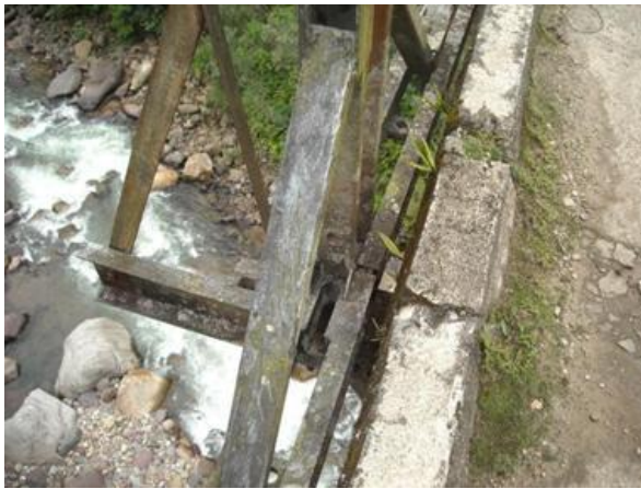
foto 51 Puente Gzaunta - Medina - Se observa deterioro en bordillos - Fuente propia
