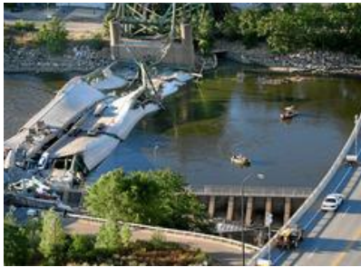
foto 32 Colapso del puente Minneapolis por deficiencia estructural(Thompson, 1993)
