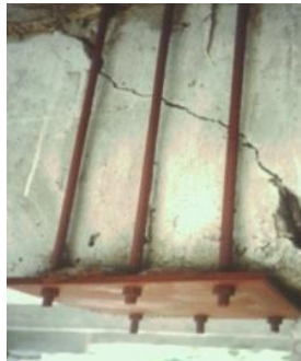
foto 34 Grieta a cortante en viga principal de concreto reforzado, con un espesor mayor a 0,6mm(Muñoz, E. E., 2011)
