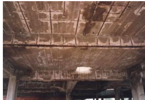
foto 22 Corrosión en concreto y pérdida de material (Ray et al., 2007)
