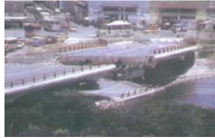
foto 31 Ejemplo de puente colapsado por deficiencia estructural , Puente Heredia (Cartagena) (Muñoz, E. E., 2011)
