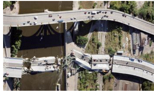
foto 33 Colapso por deficiencia estructural en las pilas de acero del puente St. Paul (Thompson, 1993)
