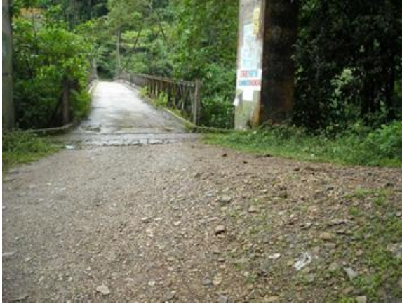
foto 49 Puente Gzaunta - Medina - Se observan hundimientos del terraplén de acceso - Fuente propia
