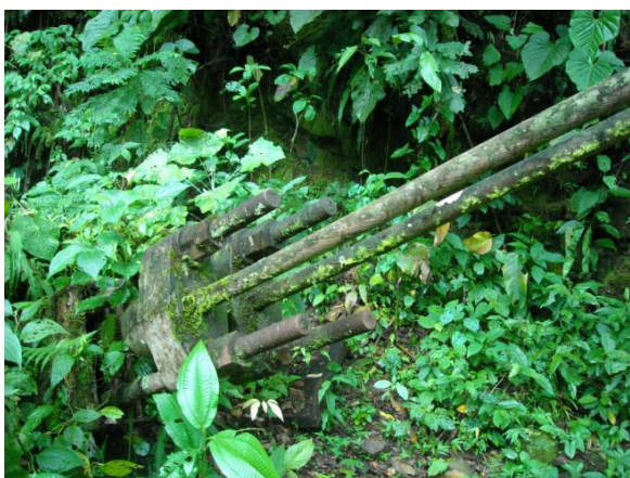
foto 47 Puente Gzaunta - Medina - Se observa acumulación de materia orgánica en cables - Fuente propia
