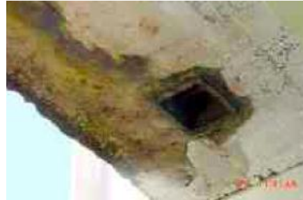
foto 20 Problemas de infiltración por malos drenes (Muñoz & Valbuena, 2004)
