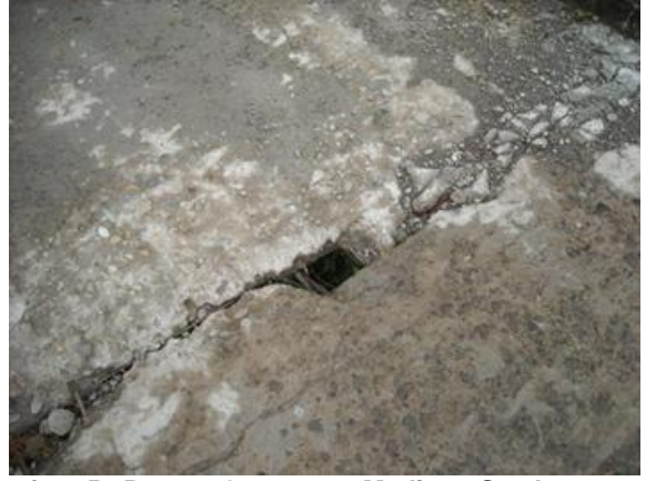
foto 50 Puente Gzaunta - Medina - Se observa ausencia de Juntas de expansión - Fuente propia
