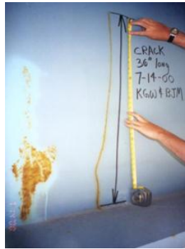
foto 13 Monitoreo de grieta por fatiga («BRIDGE INSPECTION MANUAL Chapter 11: Fatigue/Fracture Critical», 2010)
