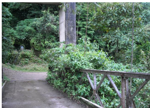
foto 48 Puente Gzaunta - Medina - Se observa acumulación de materia orgánica en barandas y estructura metálica - Fuente propia
