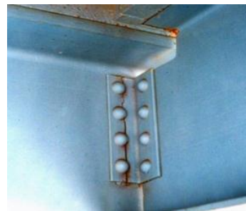
foto 12 Grieta por fatiga localizada («BRIDGE INSPECTION MANUAL Chapter 11: Fatigue/Fracture Critical», 2010)
