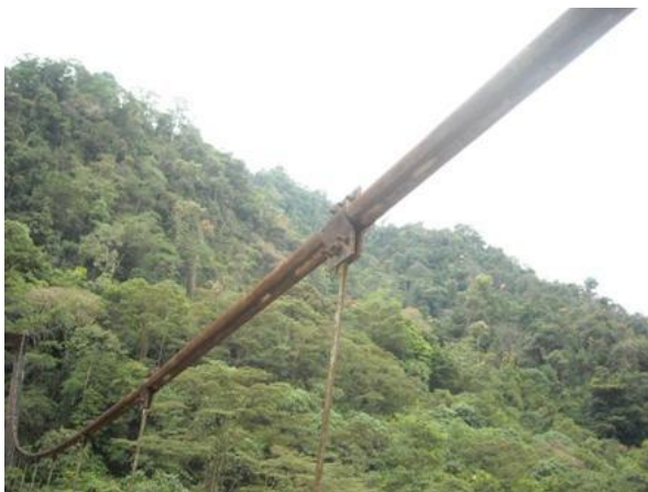
foto 45 Puente Gzaunta - Medina - Se observa corrosión en cables y pendolones - Fuente propia
