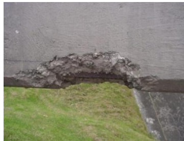
foto 29 Impacto por insuficiente galibo y acero expuesto. Puente localizado en la calle 26 con cra 3 Bogotá(Muñoz, E. E., 2011)
