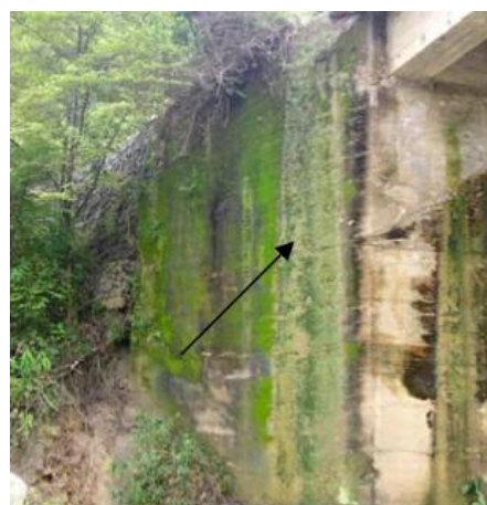
foto 24 Contaminación en el concreto de las aletas y materia orgánica (DE & FLEXIBLES, s.f.)
