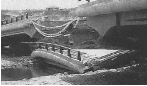
foto 30 Ejemplo de puente colapsado por deficiencia estructural, Puente Heredia (Cartagena) (Muñoz, E. E., 2011)
