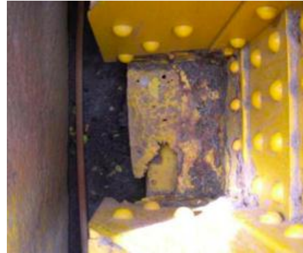
foto 17 Corrosión severa en una platina. Puente La Palmera(Muñoz & Valbuena, 2004)
