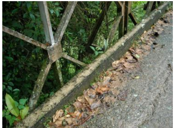
foto 52 Puente Gzaunta - Medina - Se observa corrosión en barandas - Fuente propia
