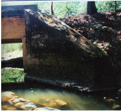
foto 5 Estado de Socavación de una aleta del puente Caño Largo (Cesar) (Muñoz Edgar y Valbuena Edgar, 2006)
