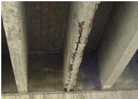
foto 21 Corrosión de acero expuesto por falta de recubrimiento (Ray et al., 2007)
