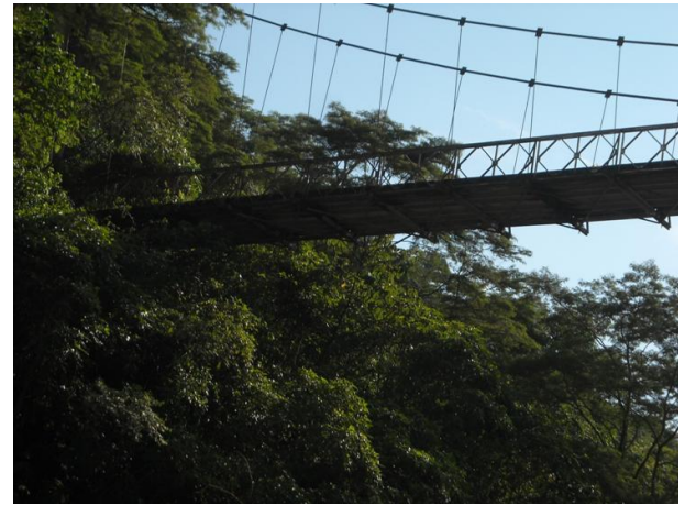
foto 40 Puente Gazaunta - Medina se observa - Cables, pendolones, armadura metálica y losa - Fuente propia
