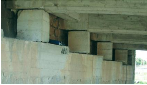
foto 25 Manchas en el concreto de los estribos («MANUAL DE INVENTARIO OBRAS DE PASO», 2009)
