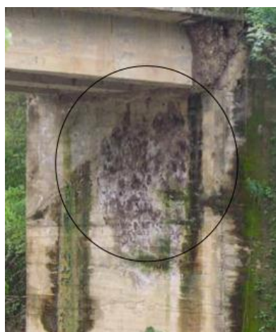
foto 23 Presencia de manchas en el concreto y humedades concentradas (DE & FLEXIBLES, s.f.)
