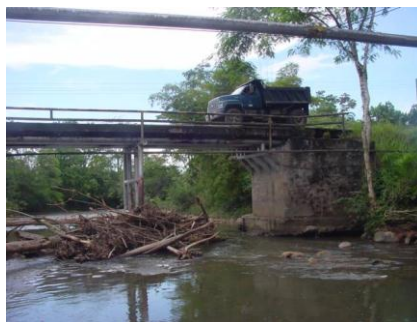
foto 9 Obstrucción del cauce. Cruce Yarumo Cauce2(Muñoz Edgar y Valbuena Edgar, 2006)
