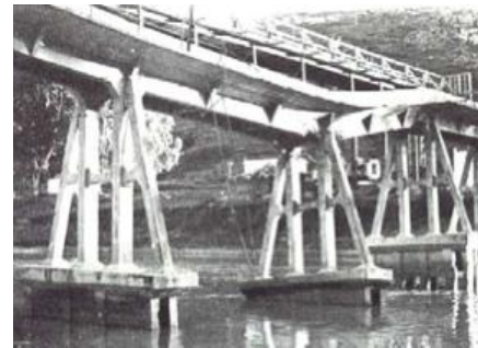
foto 8 Falla por socavación de pilas (Ponce Delgado, 2003)
