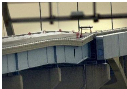
foto 11 Falla por fatiga en elemento («BRIDGE INSPECTION MANUAL Chapter 11: Fatigue/Fracture Critical», 2010)
