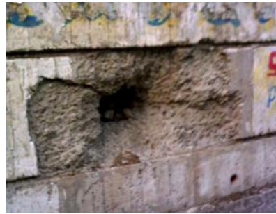
foto 28 Perdida de sección por impacto(DE & FLEXIBLES, s.f.)
