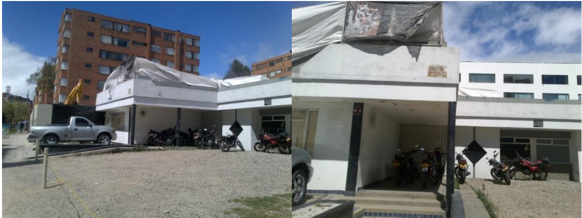
Fotografía: Demolición sin valla informativa. Cra 18 No 93 B 32 Fecha: 07/2013
