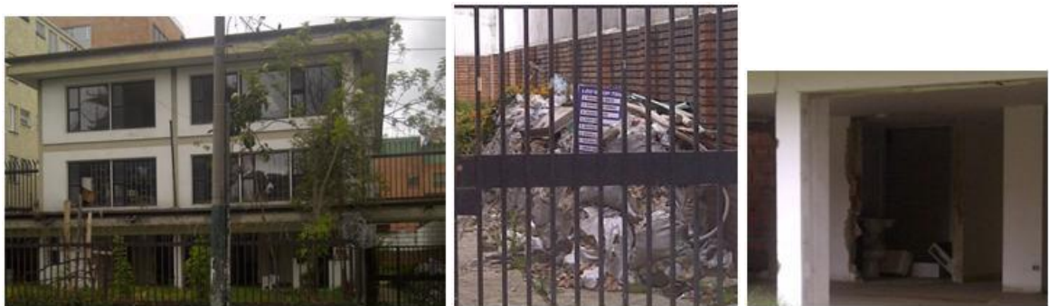
Fotografía: Desmantelamiento y demolición de edificación sin publicar valla informativa. CII 92 No 19 - 50 Fecha: 08/2013
