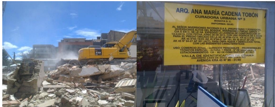
Fotografías: RCD y valla de identificación para obra nueva y demolición total INVERSIONES SAS RICORADI. Autopista Norte Cll 94 Costado Occidente - AVCra 45 No 94 -13 y 15. Fecha: 07/2013
