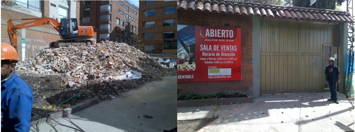
Fotografía: Demolición sin valla informativa. Diagonal 92 No 93 A 10 Fecha: 07/2013
