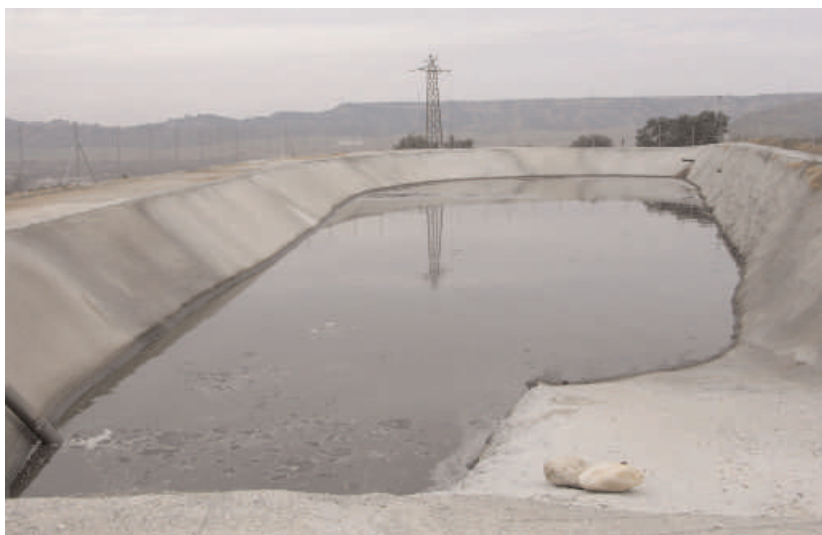
Figura 2. Fosa de almacenamiento de purín
