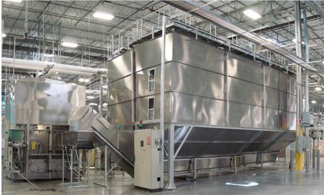
Figura 9. Silos para almacenamiento.
