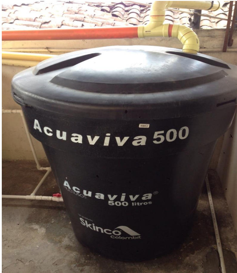
Figura 22. Tanque de almacenamiento
