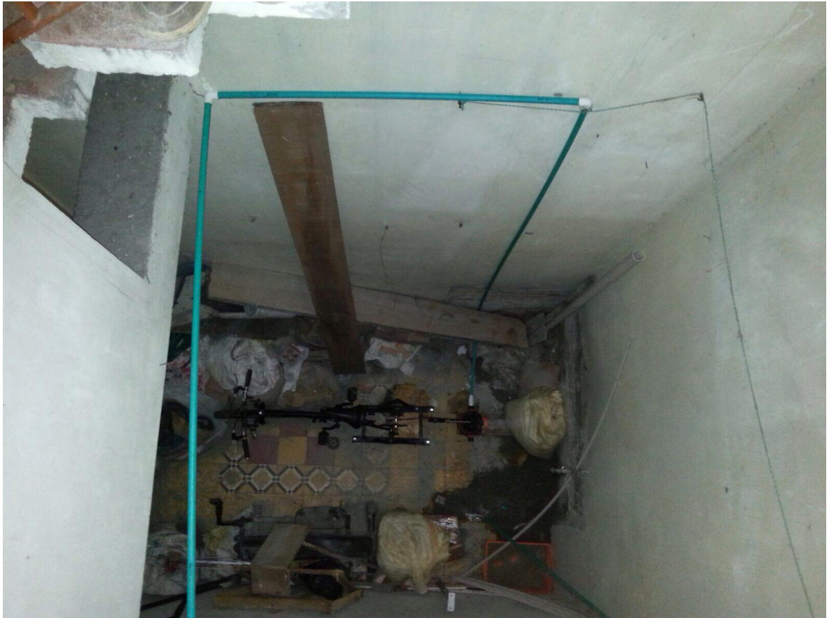
Figura 33. Ramificación de tubería del primer piso al segundo
