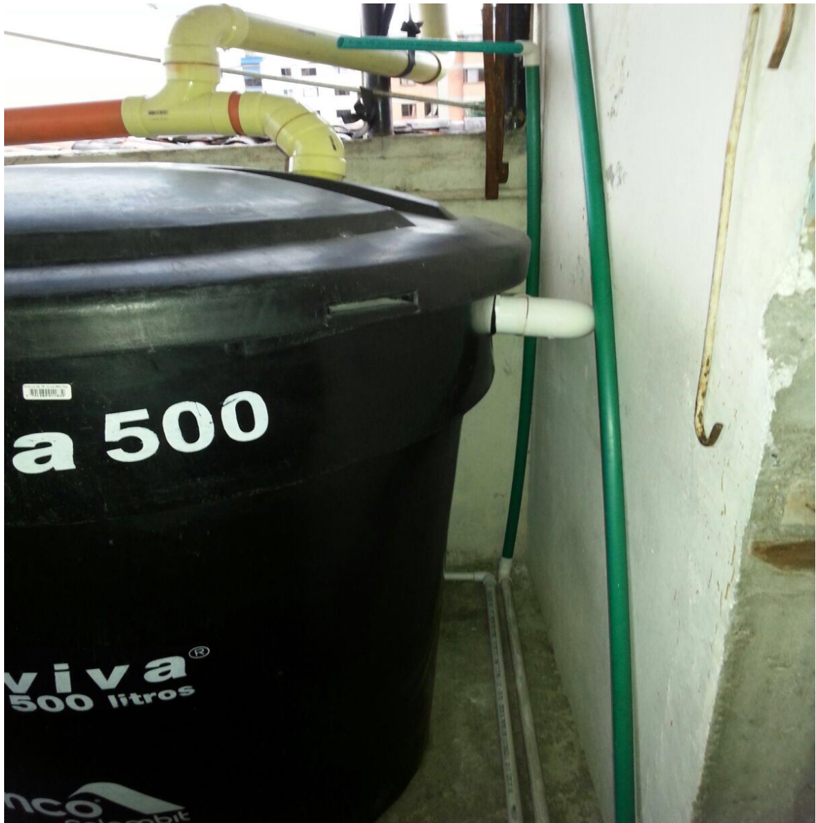
Figura 36. Conexión al tanque de almacenamiento
