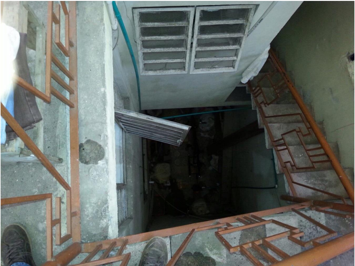
Figura 34. Ramificación de tubería del segundo al tercer piso
