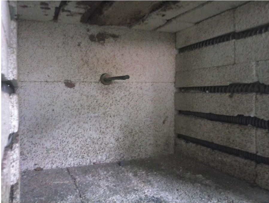
Figura 2 Interior de horno eléctrico UTP
