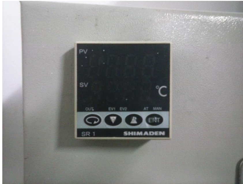
Figura 3 Controlador de temperatura usado en horno de laboratorio de metalografía UTP
