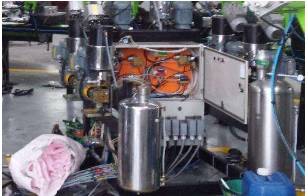
Figura 10. Tablero de control y tanques de almacen. del equipo en Goby
