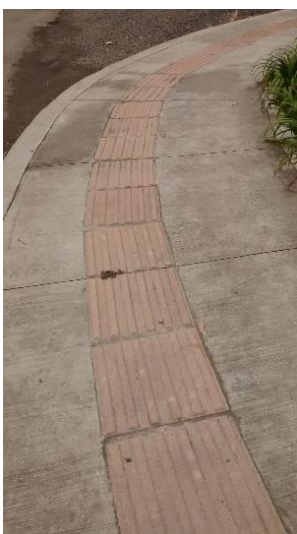
Fotografía 7 - Entrada G - UTP. Señalización táctil
