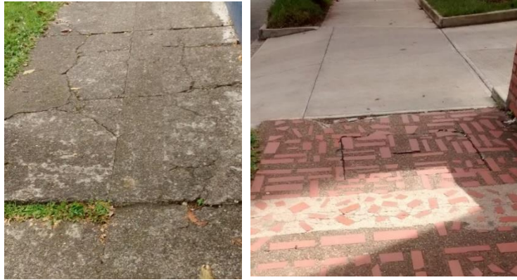
Fotografía 10 - Deterioro de la franja peatonal
