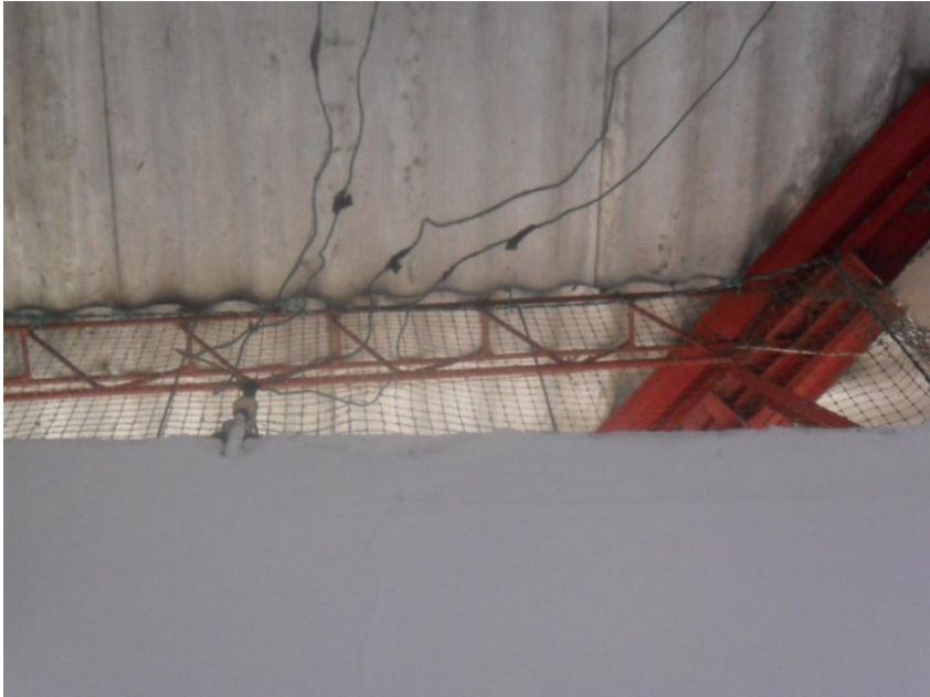
Ilustración 15 CONDUCTORES SIN DUCTOS
