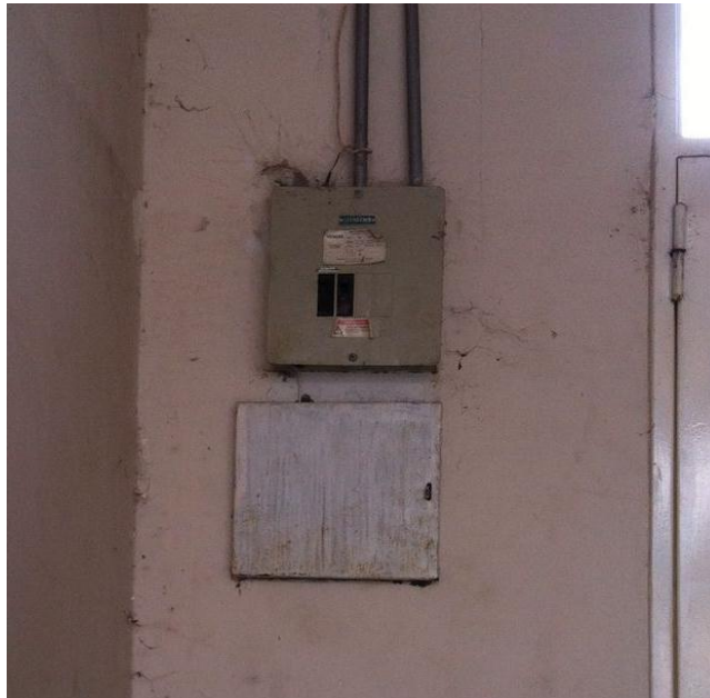
Ilustración 8 TABLERO GENERAL CARCASA
