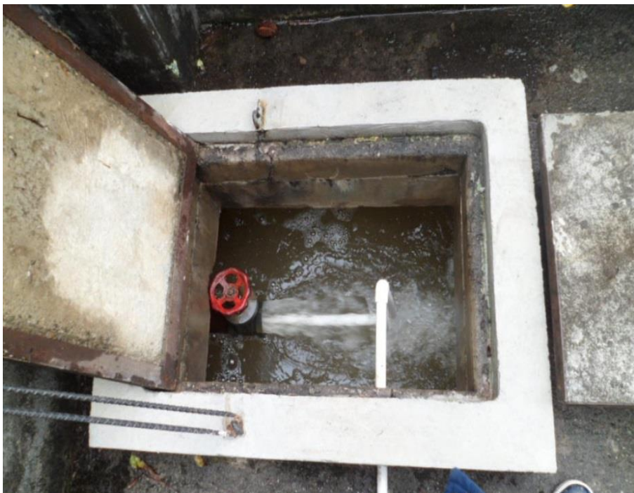
Imagen N° 5. Tanque de captación corregimiento de Santa Ana.
