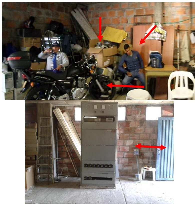
Figura 5. Cuarto del tablero general.
