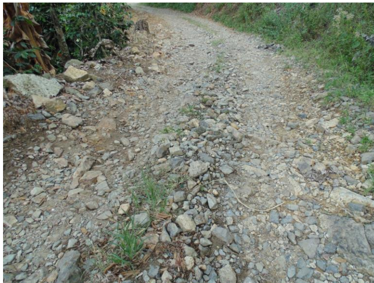
Fotografía 8. Estado de las vías
