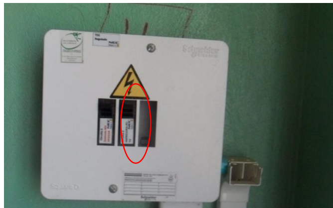
Figura 14. Tablero 4 Salón 2 con tapa de protección
