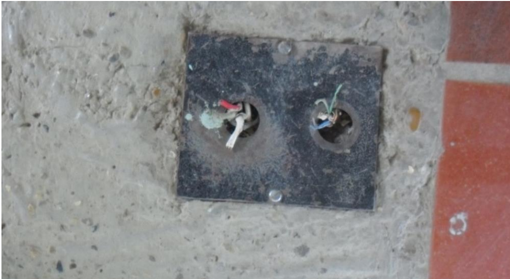
Figura 32. Ausencia de Tomacorriente
