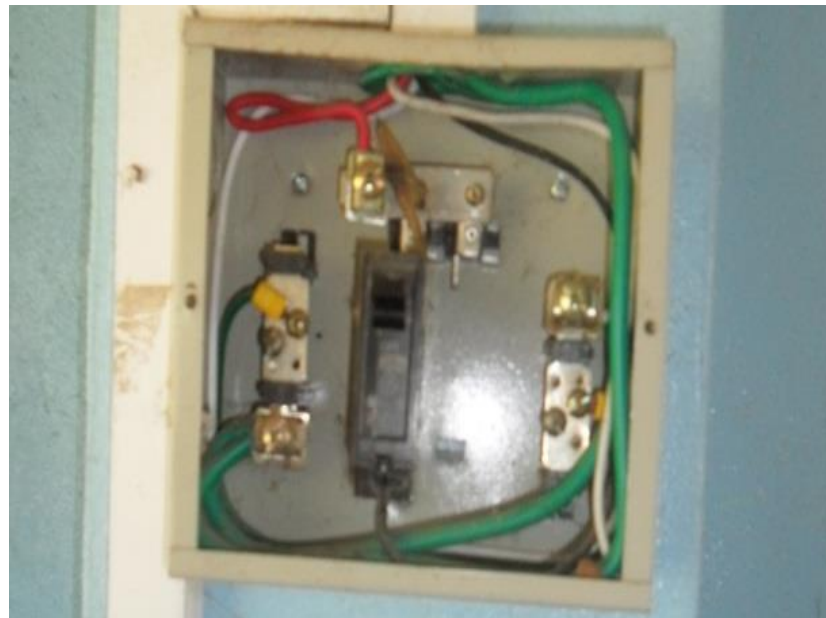
Figura 15. Tablero 5 Salón 2 sin tapa de protección
