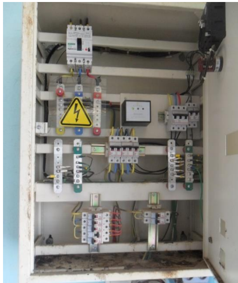
Figura 19. Tablero 7 Salón 4 sin tapa protectora
