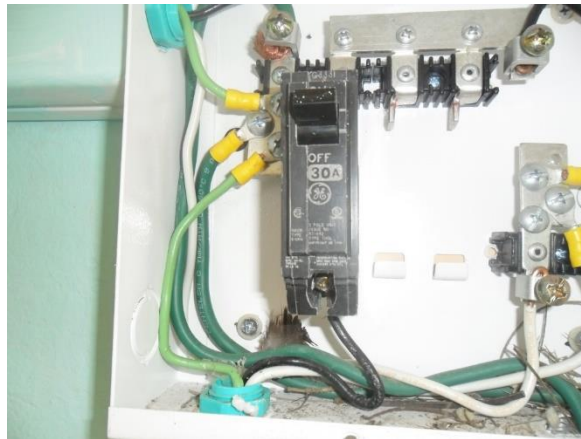
Figura 22. Tablero sin tapa de protección
