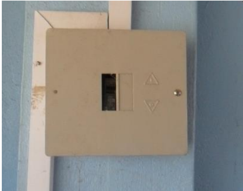
Figura 16. Tablero 5 Salón 2 con tapa de protección
