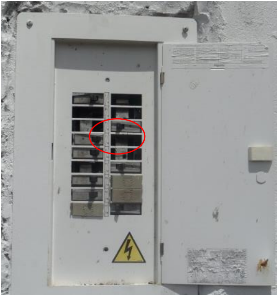
Figura 27. Tablero Antiguo con tapa de protección
