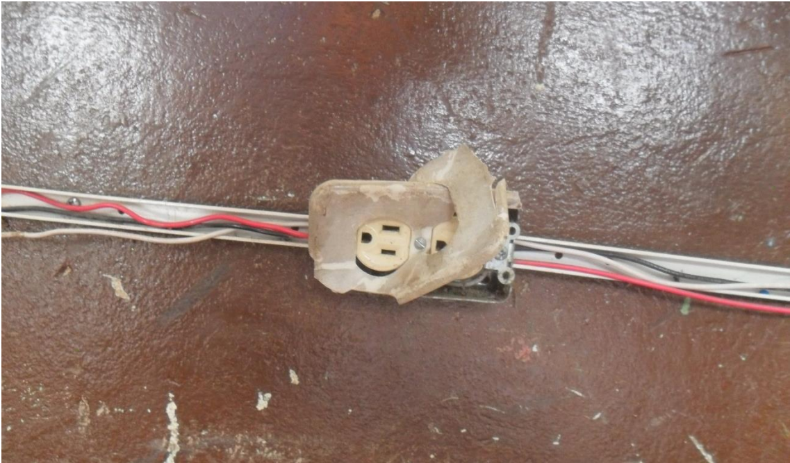
Figura 33. Tapa del Tomacorriente en mal estado
