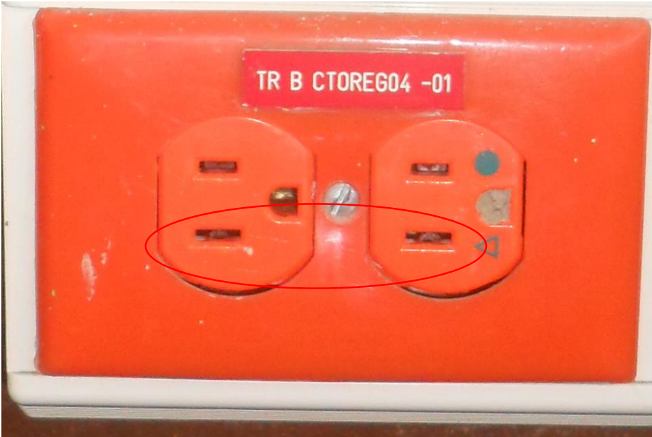
Figura 31. Tomacorriente mal instalado
