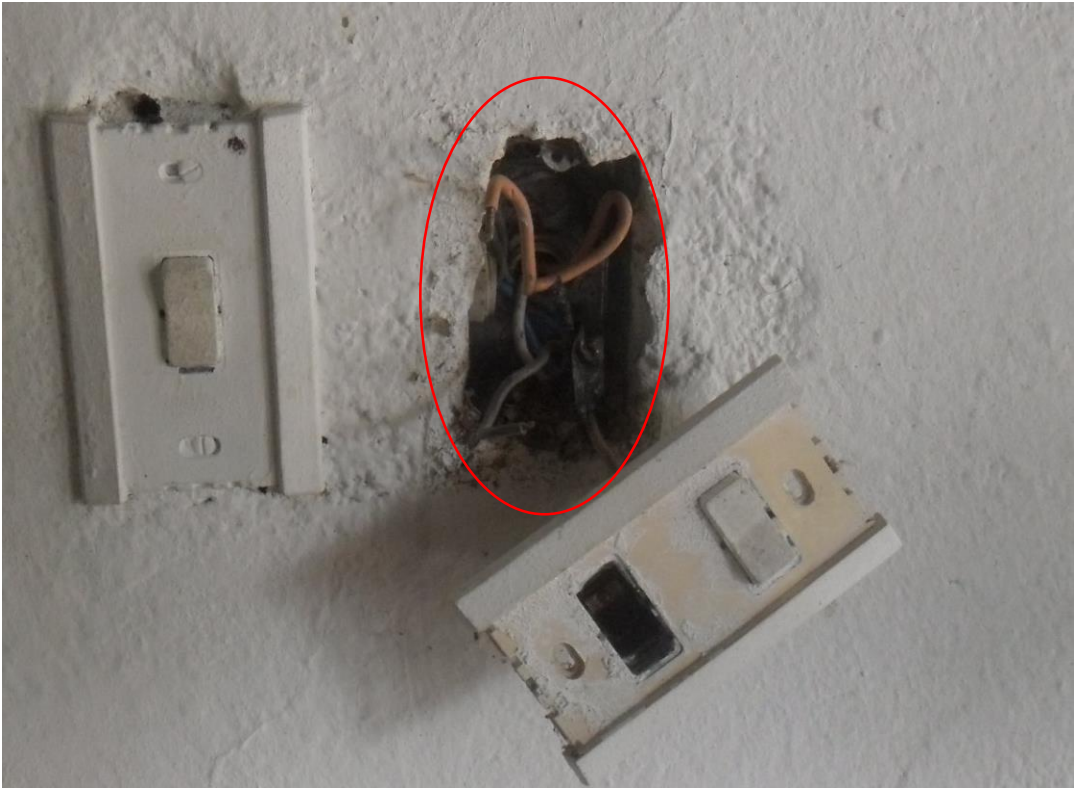
Figura 34. Interruptor en mal estado
