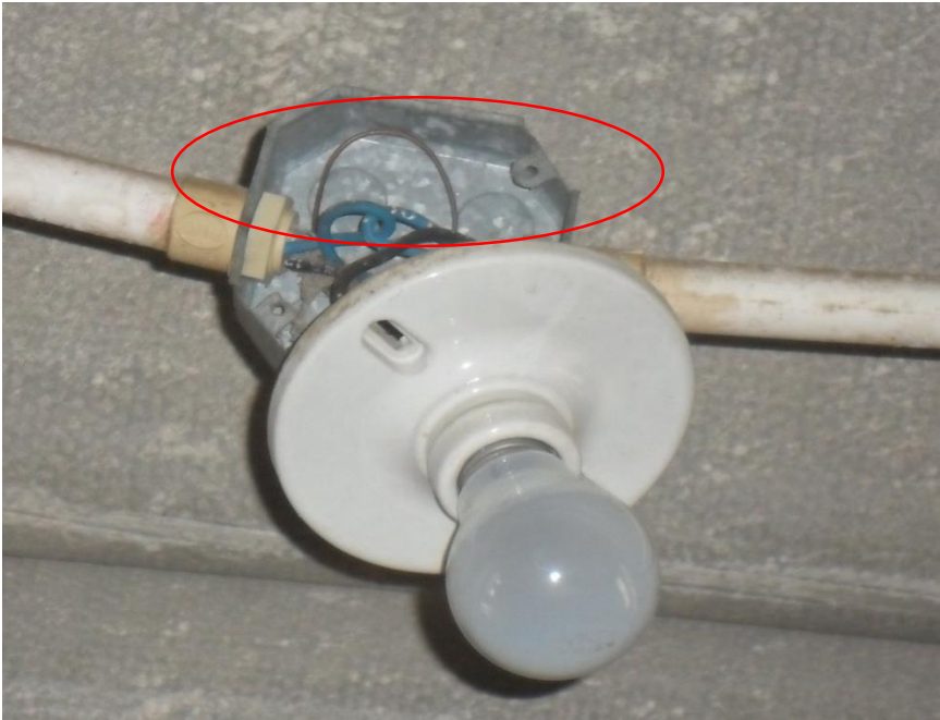
Figura 35. Salidas de iluminación en mal estado y fuera de servicio
