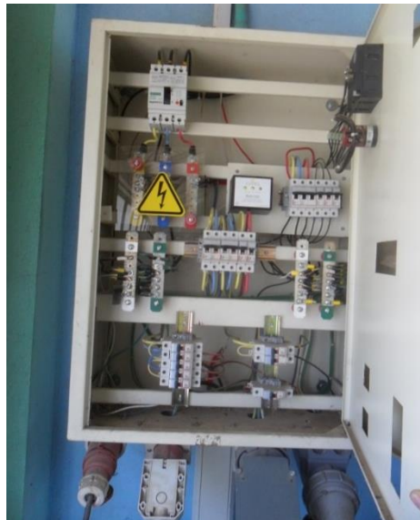
Figura 11. Tablero 3 Salón 2 sin tapa protectora
