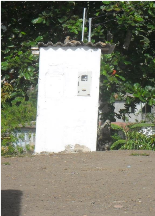
Figura 2. Línea de alimentación antigua
