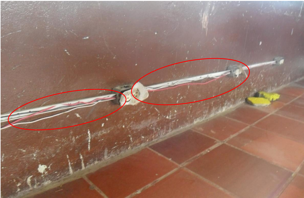
Figura 36. Canalizaciones en mal estado
