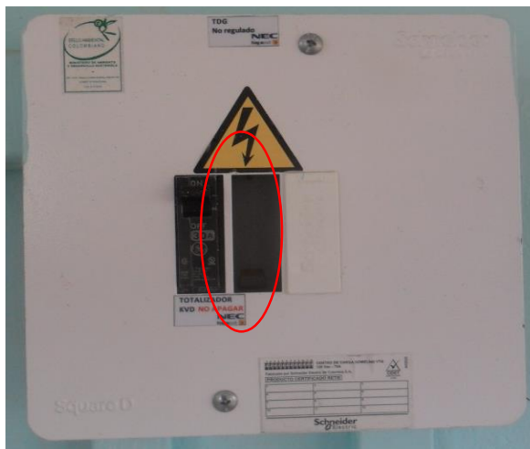
Figura 23. Tablero con tapa de protección
