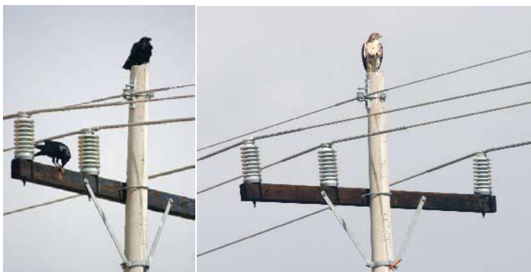
Figura 23: Aves posadas en estructuras eléctricas
