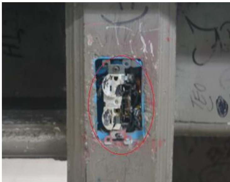
Figura 44. Tomacorriente en mal estado.
