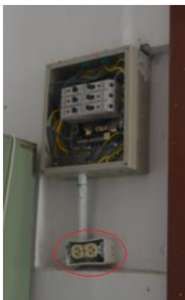
Figura 29. Abertura no cubierta Tablero 12.
