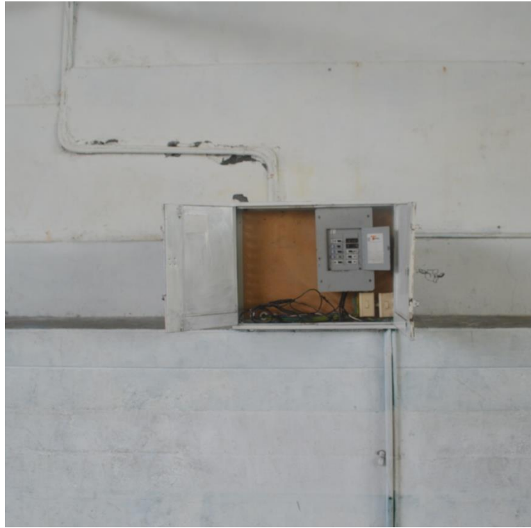
Figura 7. Conductores línea de alimentación 2.
