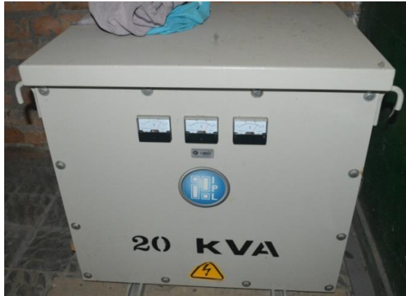
Figura 10. Acondicionador de la línea de alimentación 3.
