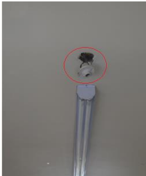
Figura 52. Plafón sin conectar.
