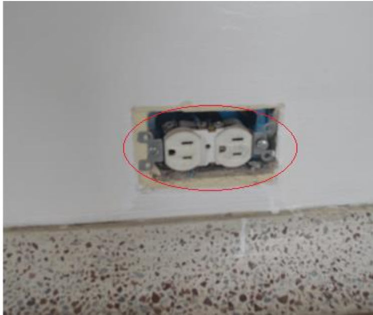
Figura 43. Tomacorriente sin carcasa.
