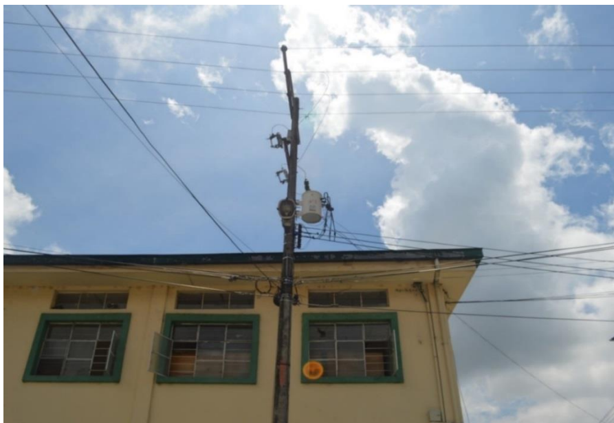
Figura 1. Línea de alimentación 1.
