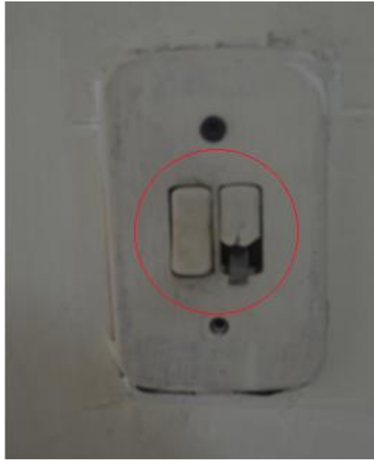
Figura 51. Interruptor en mal estado.
