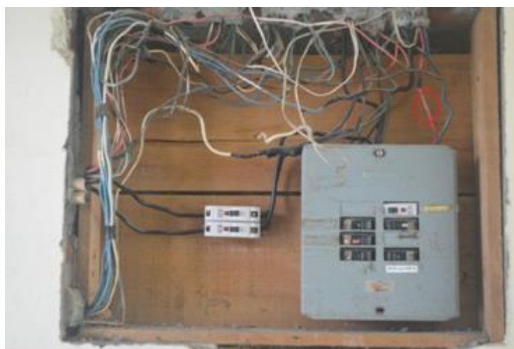
Figura 2. Conductores en deterioro
