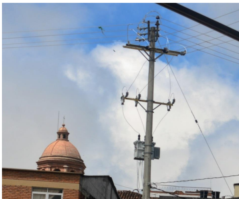
Figura 6. Línea de alimentación 2.
