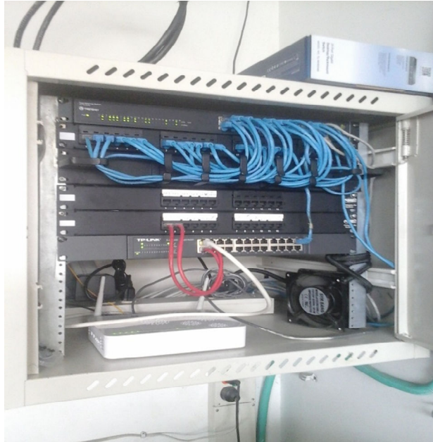
Figura 44. Gabinete único (rack de pared).
