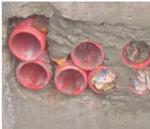
Figura 59. Canalización subterránea para cableado estructurado.
