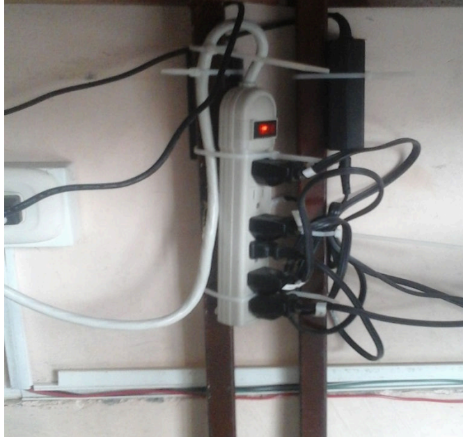
Figura 42. Cables sin la canalización adecuada.
