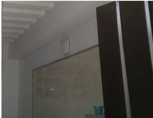
Figura 45. Punto de acceso en salón de clases.
