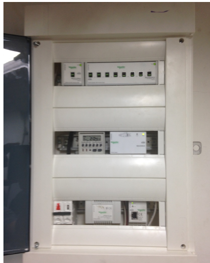
Figura 75. Tablero de automatización KNX
