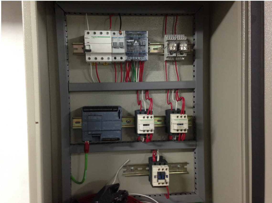
Figura 94. Tablero de transferencia
