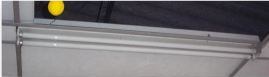
Figura 45 Lámparas adheridas al techo [5]
