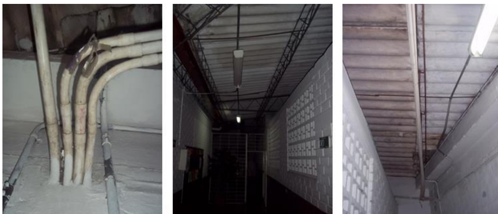
Figura 29 Cableado con tubería [5]
