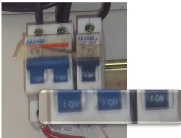
Figura 33 Accionamiento de los interruptores [5]
