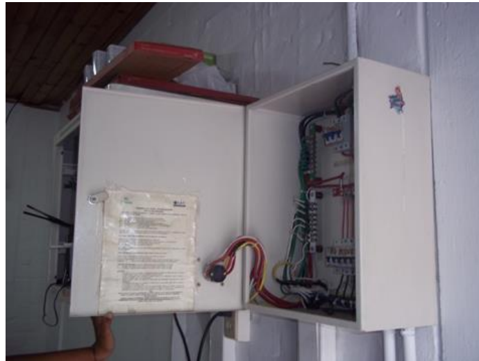
Figura 31 Gabinete sobrepuesto en la pared [5]
