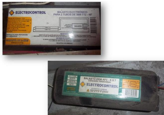
Figura 43 Parte interna luminaria (Balasto) [5]
