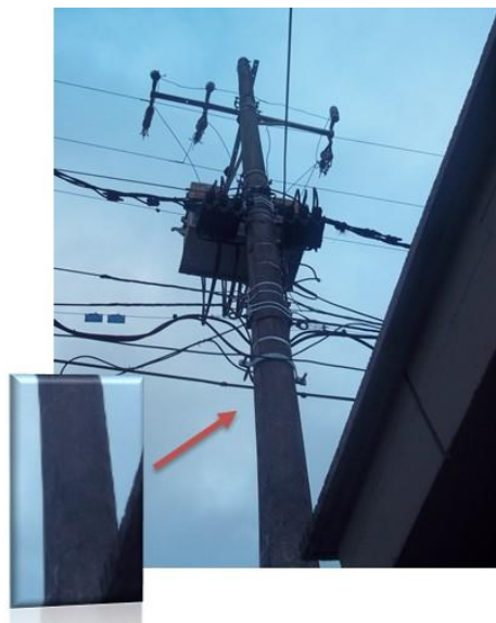
Figura 18 Sin Conductor de puesta a tierra del Transformador [5]
