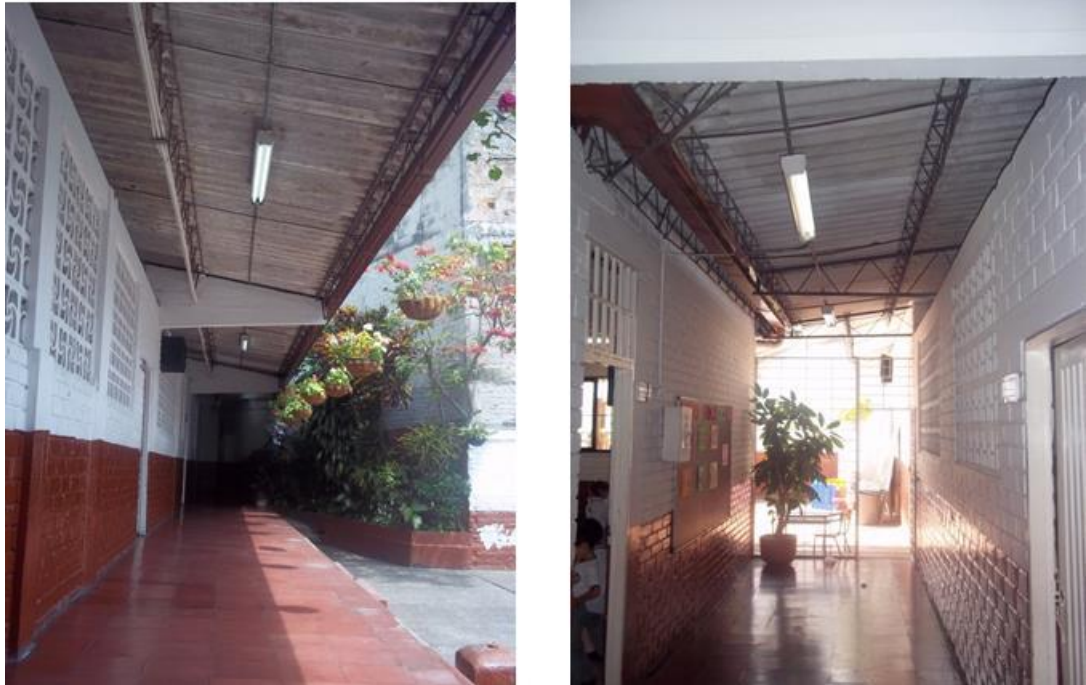
Figura 34 Pasillos con lámparas fluorescentes [5]
