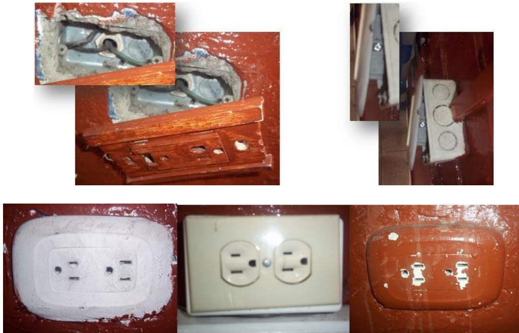
Figura 24 Estado de Tomacorrientes [5]
