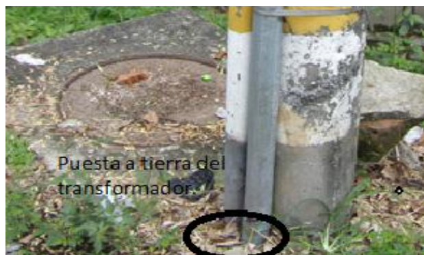
Figura 22 Puesta a tierra del transformador. [6]
