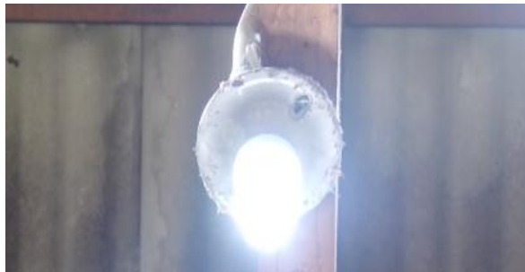
Figura 29 Baños con bombillas fluorescentes. [6]
