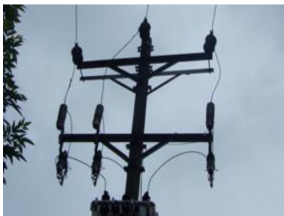
Figura 20 Pararrayos y cortacircuitos. [6]
