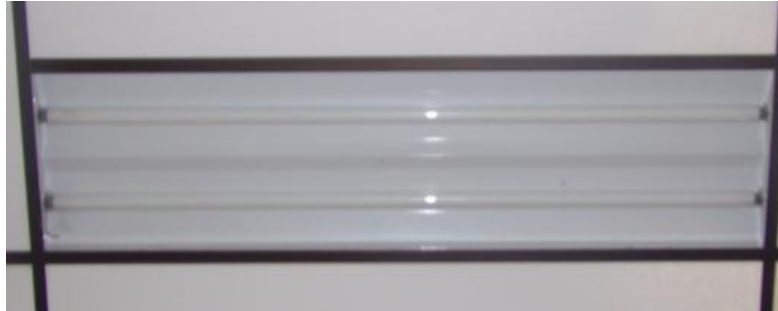
Figura 36 Luminaria fluorescente dañada. [6]
