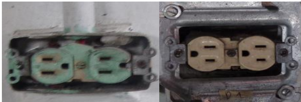
Figura 27 Tomacorrientes en mal estado. [6]
