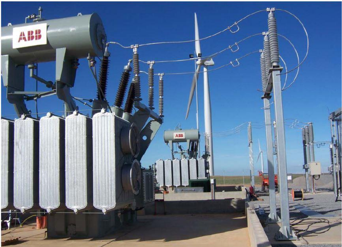
Figura 13. Transformador de potencia
