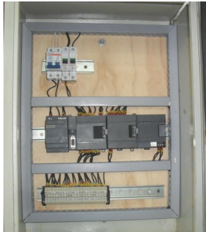
Figura 14 Cofre eléctrico de control
