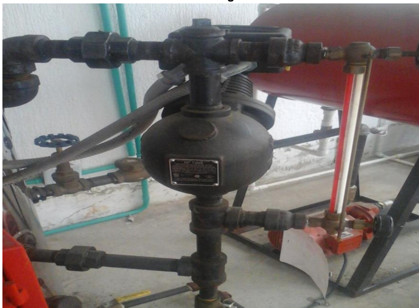
Ilustración 15 Control de nivel McDonnell & Miller de agua en la caldera.
