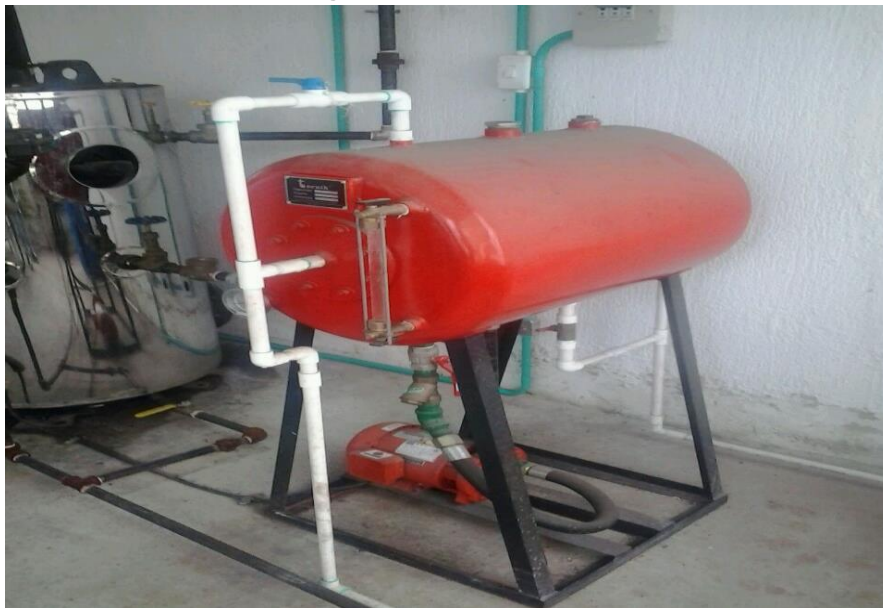
Ilustración 17 Tanque de suministro de agua.
