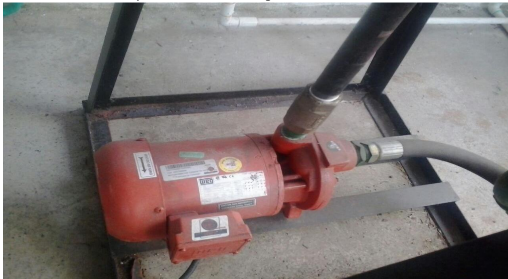
Ilustración 16 Motobomba tanque suministrador de agua IHM turbina TB-150.
