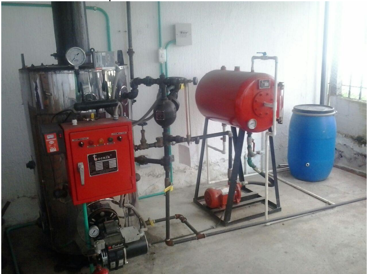
Ilustración 12 Caldera vertical pirotubular del laboratorio de Mecatrónica.
