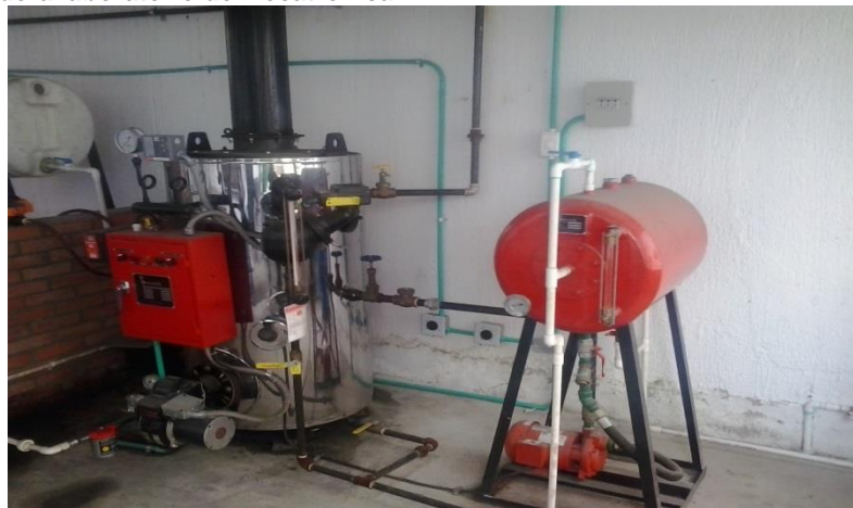
Ilustración 6 Caldera laboratorio de Mecatrónica
