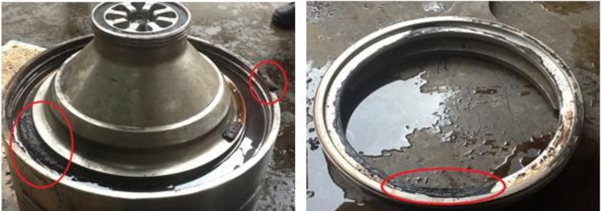
Figura 4. Suciedad en clarificadora
