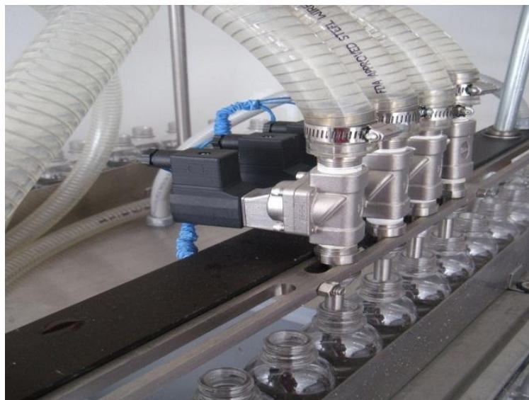
Figura 62 nuevo sistema de llenado.
