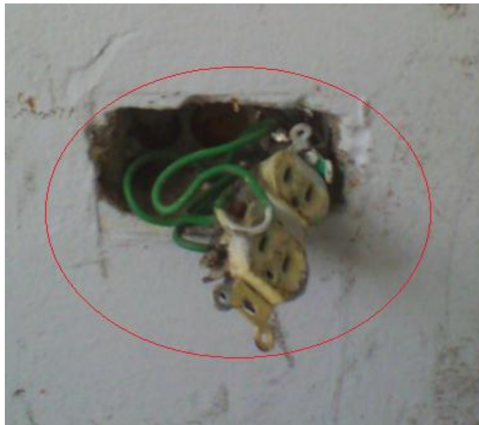
Figura 34. Tomacorriente mal instalado
