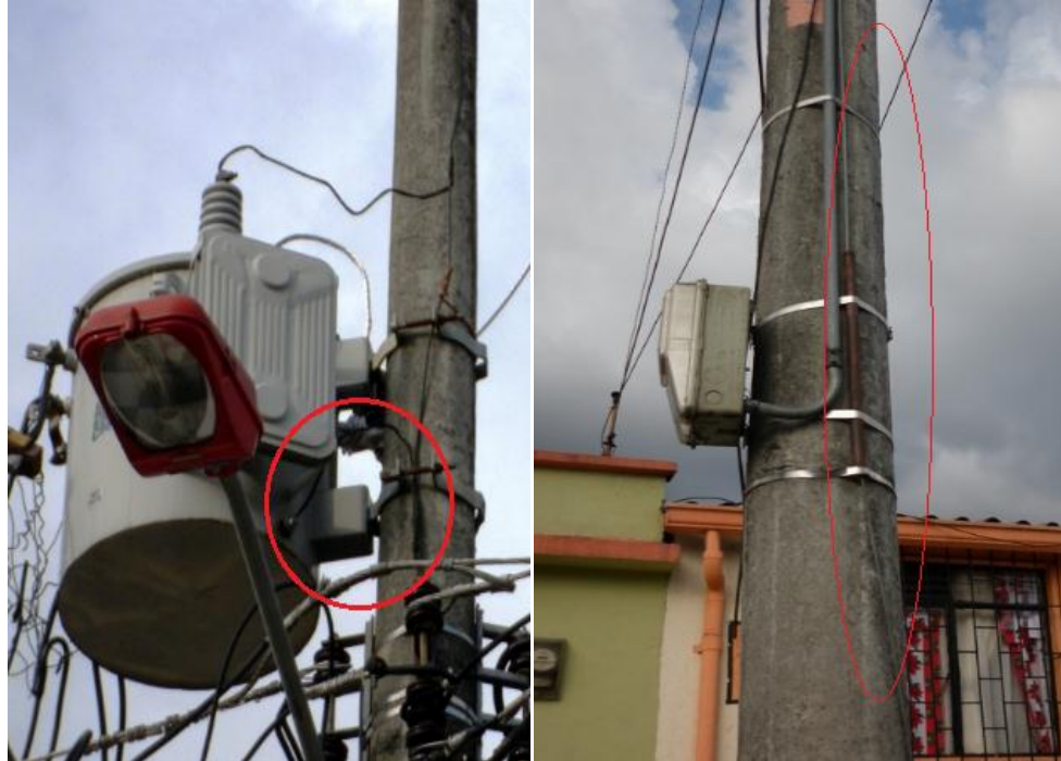
Figura 17. Conductor de puesta a tierra del Transformador
