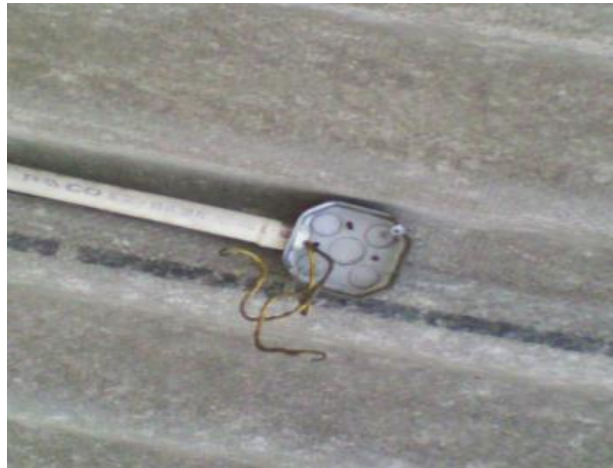
Figura 36. Conductores terminales de iluminación
