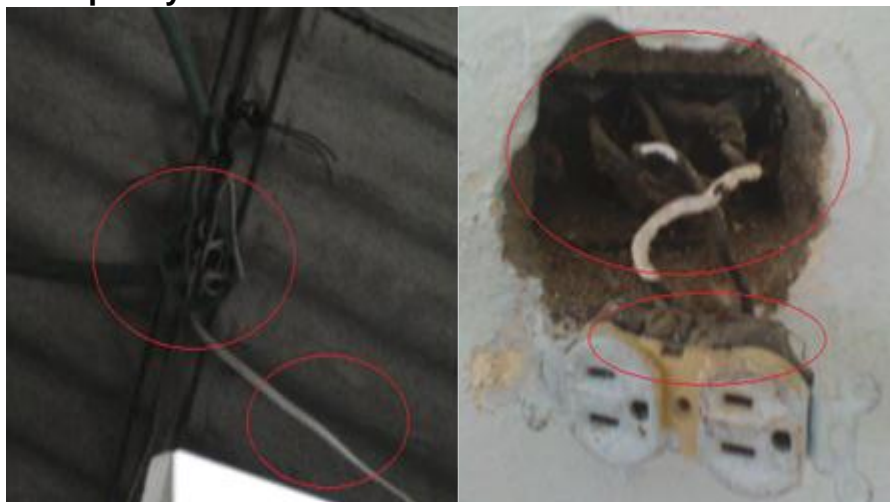
Figura 33. Lámpara y toma mal instaladas
