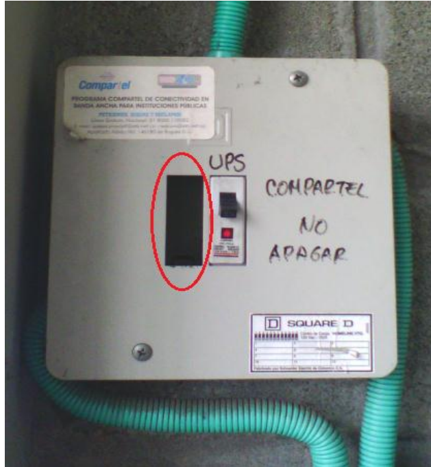
Figura 10. Aberturas no utilizadas en el tablero 7 de distribución
