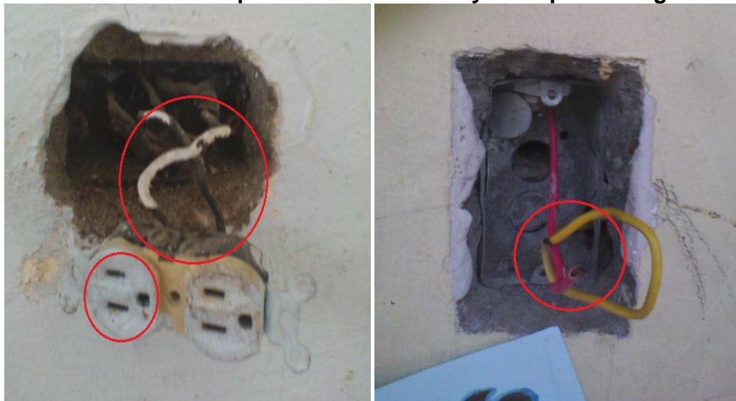
Figura 13. Tomas e interruptores en mal estado y sin tapas de seguridad
