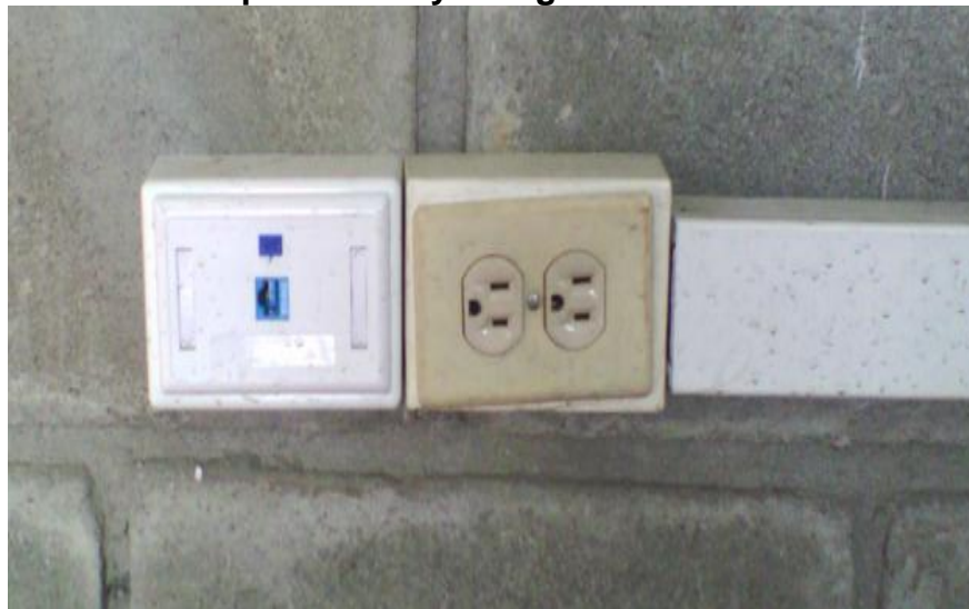
Figura 38. Canalización para datos y energía eléctrica en la sala de sistemas.
