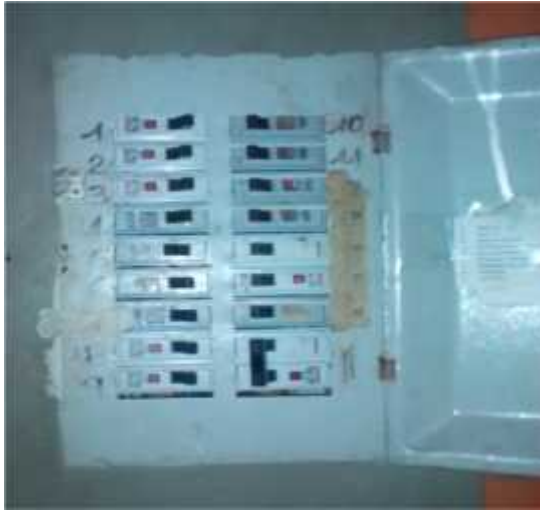
Figura31. Interruptores debidamente aislados
