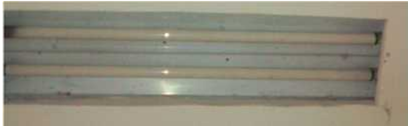
Figura44.Luminaria con tubo dañado
