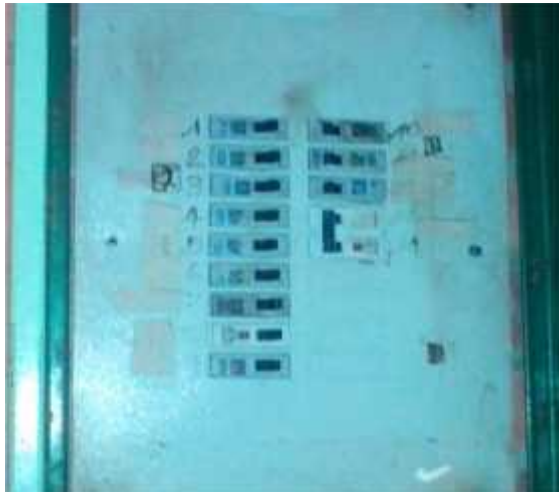
Figura 36 Tablero sin código de colores ni debidamente señalizado
