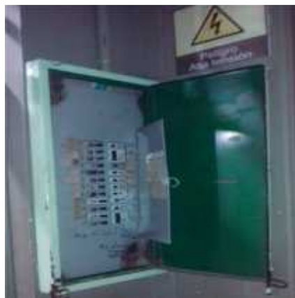
Figura24. Señalización de seguridad cuarto tablero segundo piso
