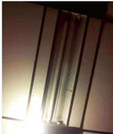
Figura45.Luminaria con ausencia de tubo
