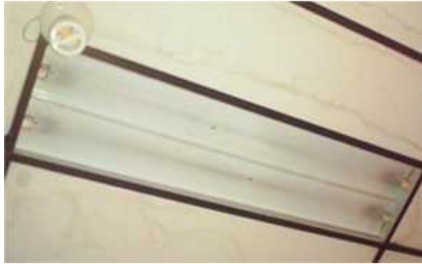
Figura43.Luminaria fuera de servicio
