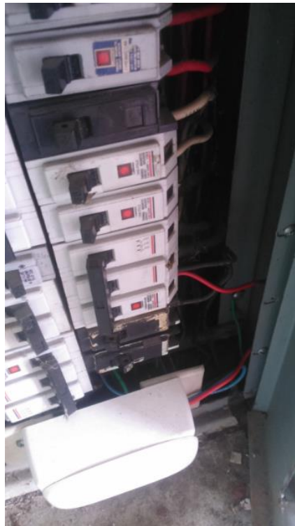
Figura 29. Gabinete eléctrico principal
