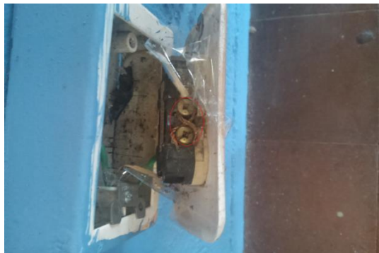
Figura 23. Cable no adecuado
