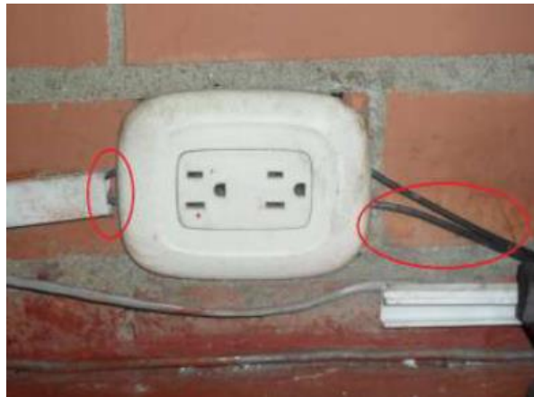
Figura 43. Cableado inadecuado (Cable dúplex)
