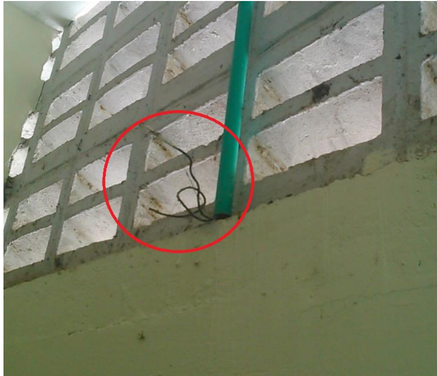
Figura 21. Cables sin aislamiento
