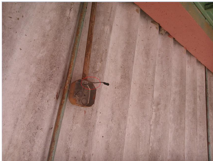
Figura 47. Caja de paso
