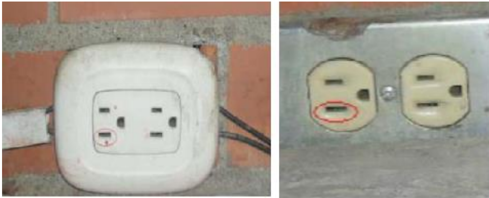
Figura 41. Posición incorrecta del contacto de neutro
