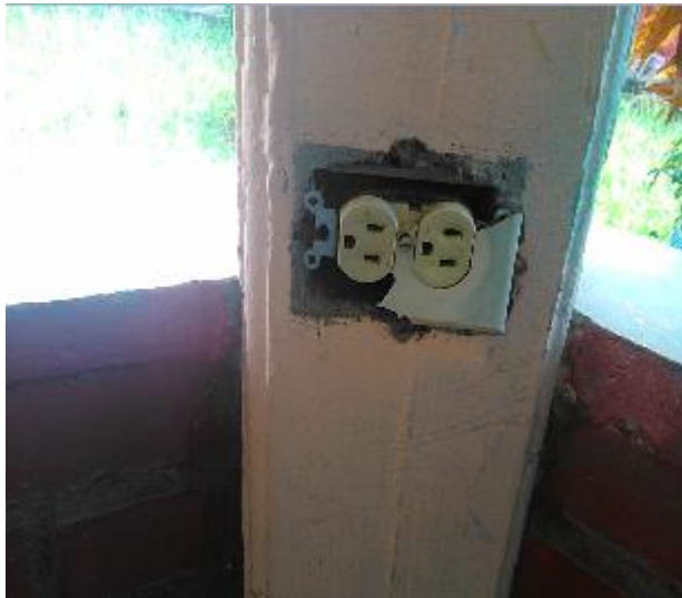
Figura 42. Tomacorriente no adecuado para el ambiente
