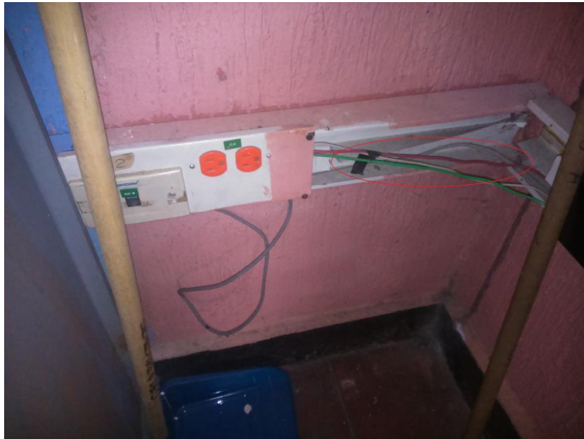
Figura 17. Conductores al descubierto
