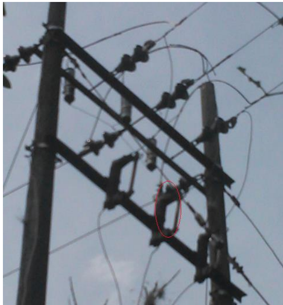
Figura 25. Pararrayos y cortacircuitos
