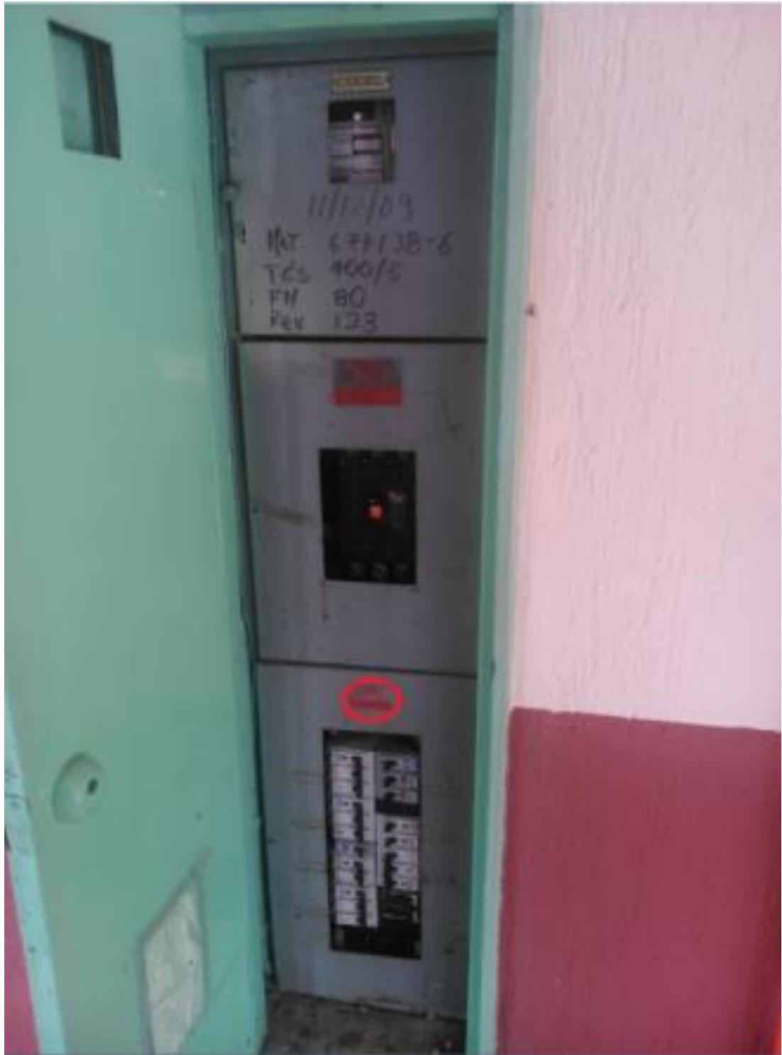
Figura 32. Identificación de características de funcionamiento.
