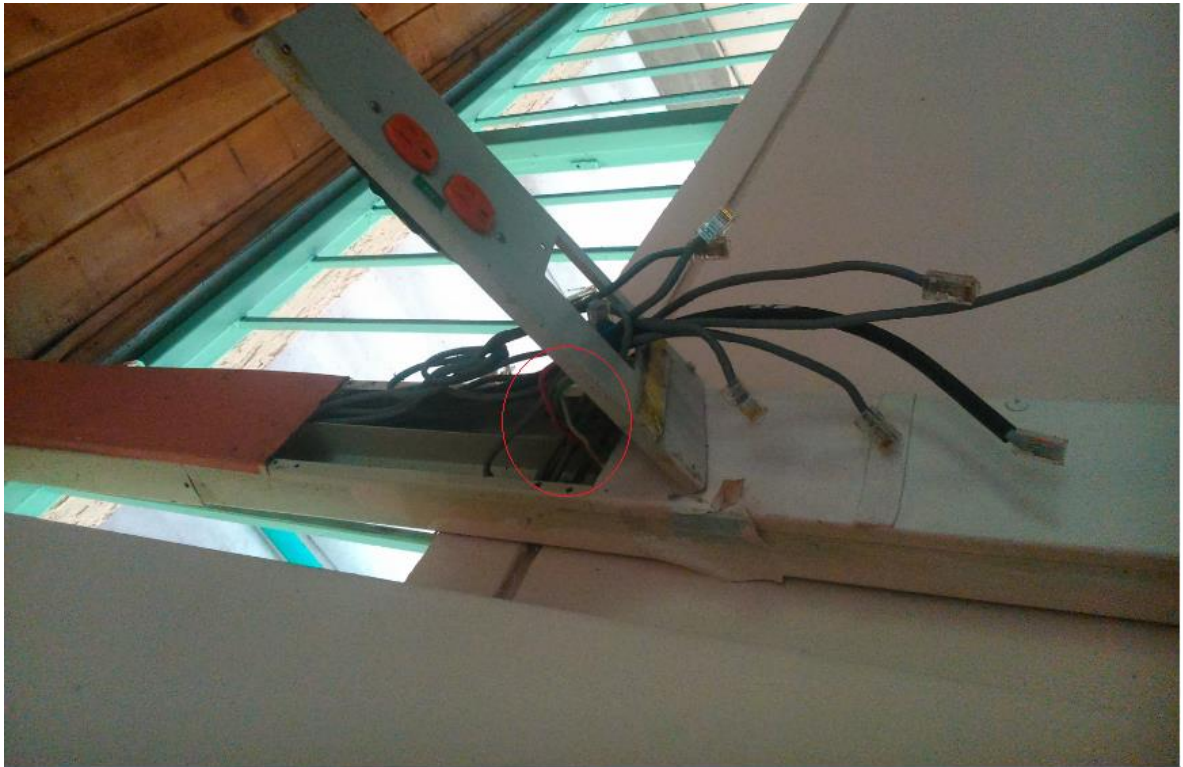
Figura 19. Canales para conductores averiados
