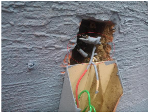
Figura 18. Orificios para elementos eléctricos al descubierto
