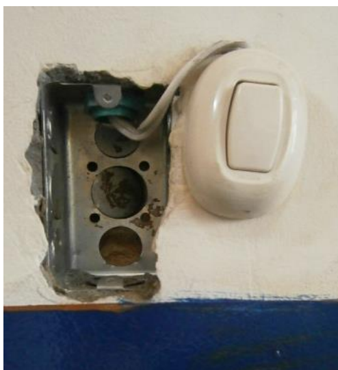
Figura 48. Caja de paso de interruptor
