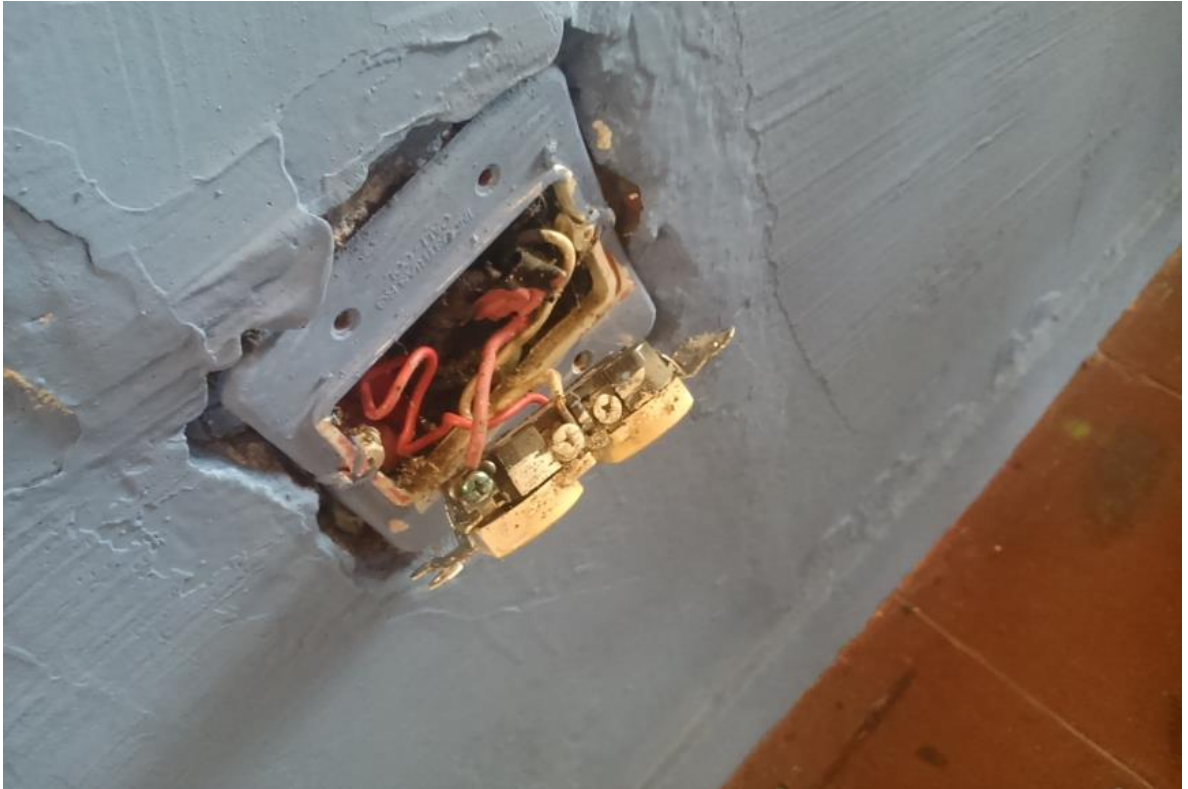
Figura 24. Ajuste mecánico defectuoso
