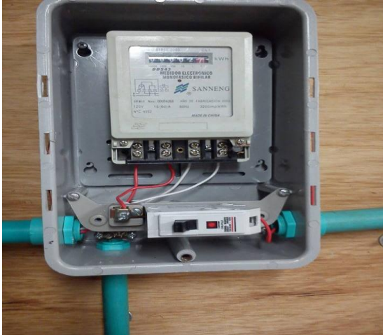
Figura 129 Conexión del medidor
