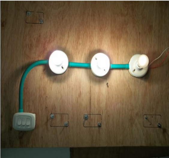
Figura 97 Salidas de iluminación de los tres interruptores
