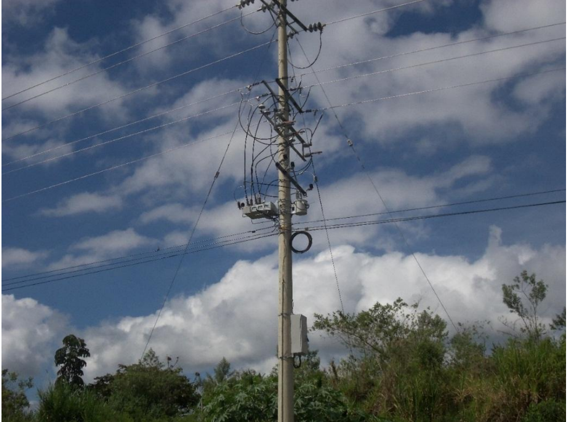
Figura 3-1 Reconectador instalado AD EDEQ SA ESP
