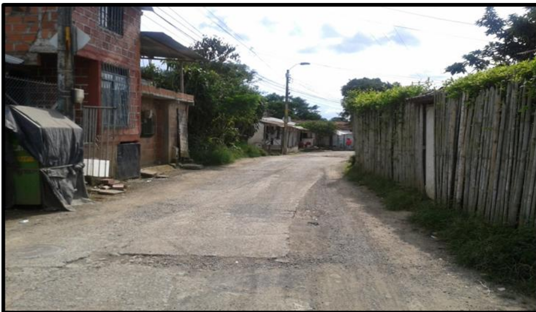
FIGURA 11: Estado de la Vía
