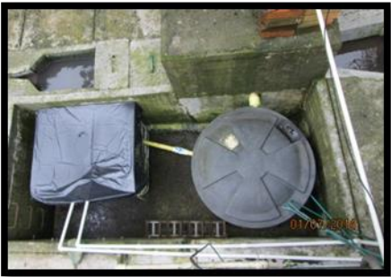
Figura 10. Tanque de sedimentación y Alimentación.
