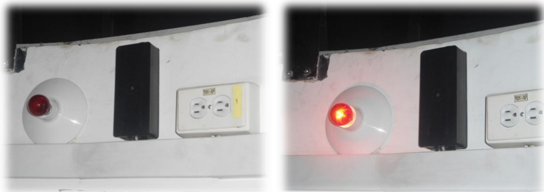
Figura 185. Acción de encendido y apagado de la luminaria mediante control web.
