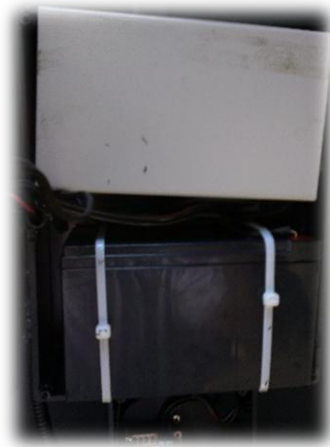
Figura 29. Batería Seca 12V/7AH y su respectivo cargador en caja de proyecto.
