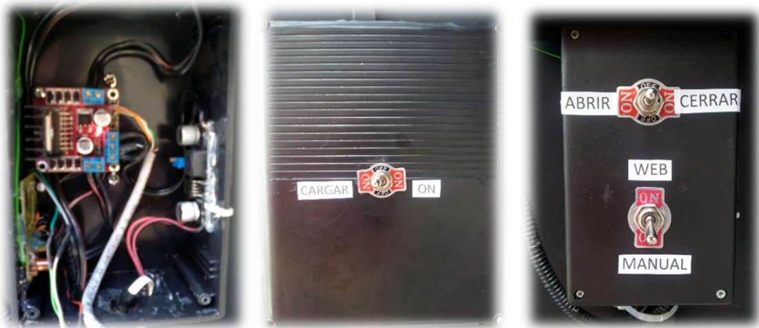
Figura 32. Cajas contenedoras de circuitos con Switch de control.
