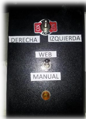
Figura 37. Caja de circuitos con Switch de control manual.
