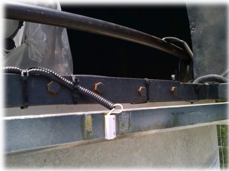
Figura 22. Sensor magnético instalado en compuerta del domo.
