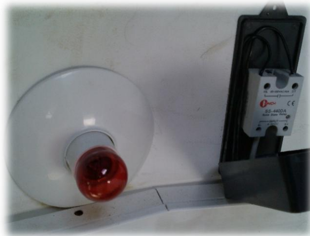
Figura 45. Dispositivos instalados para control de luminaria.
