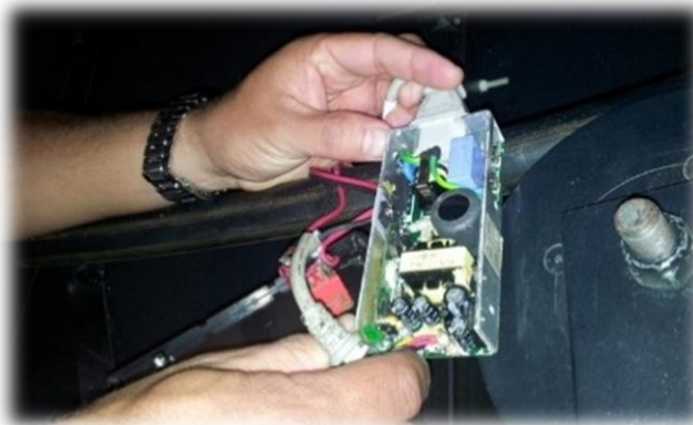
Figura 2. Fuente de tensión para motores de apertura y cierre de compuertas de la cúpula.
