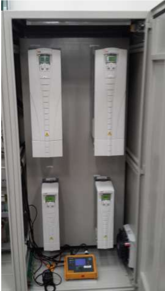
Figura 49: Imagen interior tablero de control, con automatización_3
