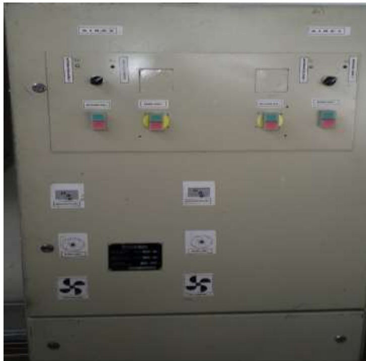
Figura 1: Exterior tablero inicial
