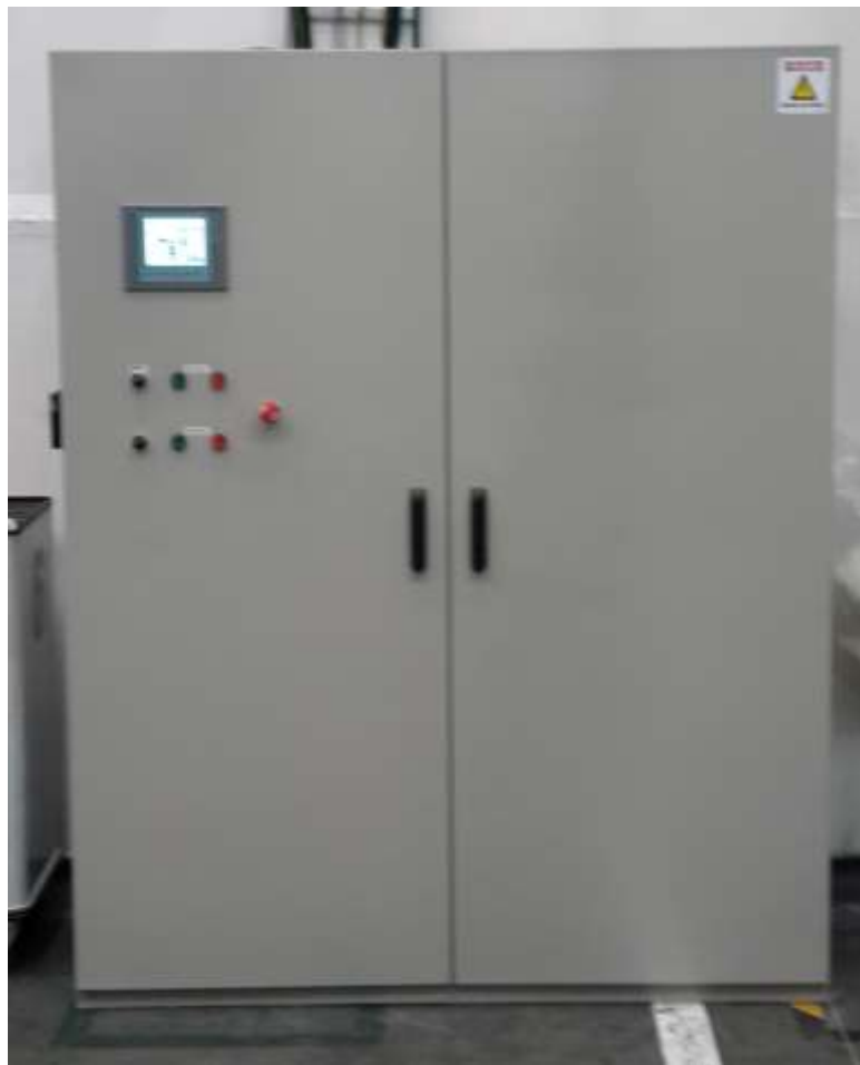
Figura 46: Imagen exterior tablero de control, con automatización
