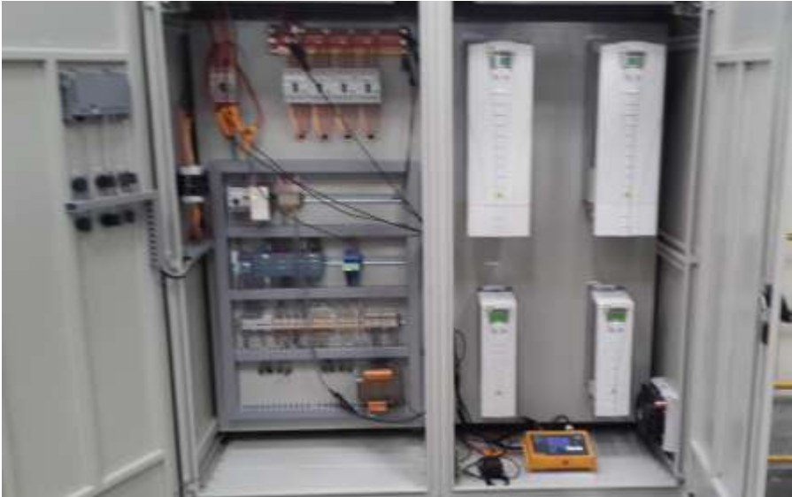
Figura 47: Imagen interior tablero de control, con automatización_1
