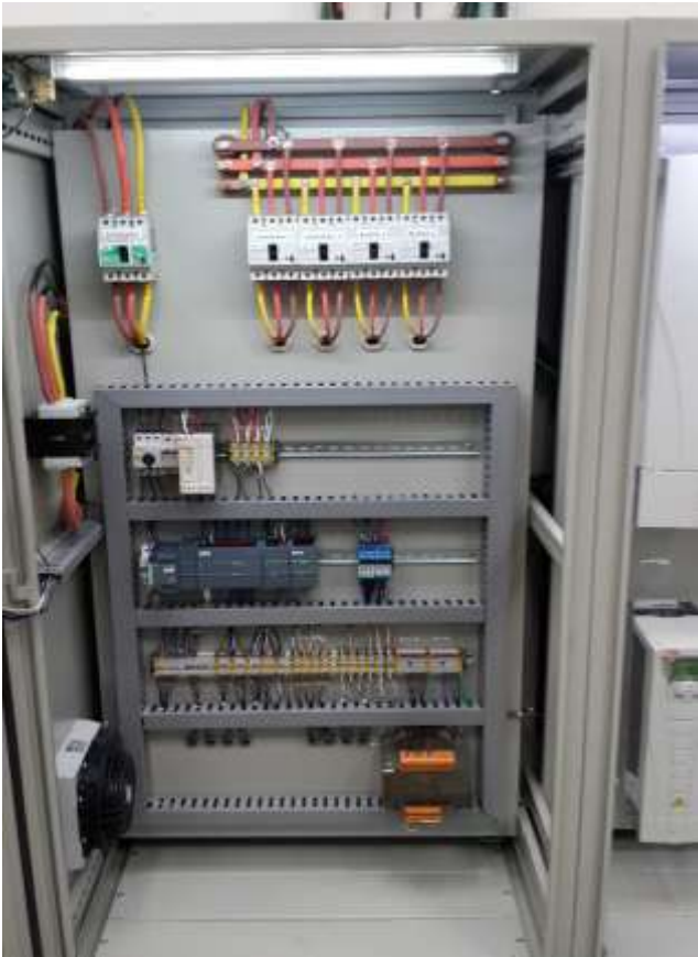
Figura 48: Imagen interior tablero de control, con automatización_2
