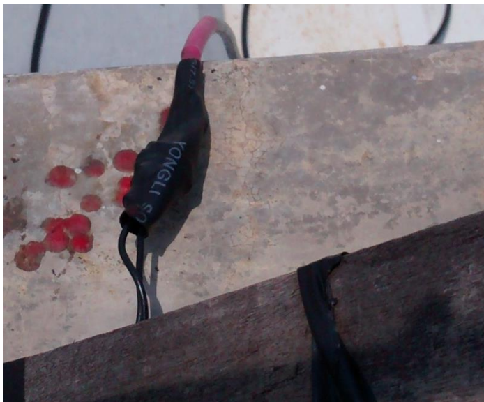
Figura 24. Conexión entre el alambre de cobre y el cable coaxial recubierto por termoencogible.
