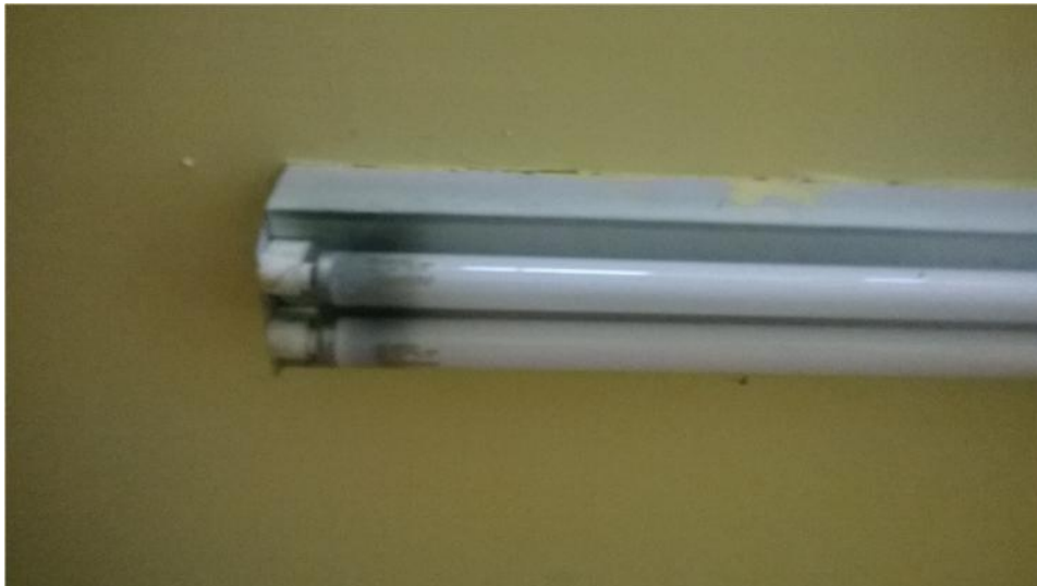
Figura 30. Luminaria ubicada en el salón 6
