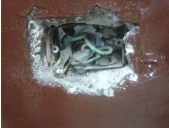
Figura 21. Caja de tomacorriente en pésimas condiciones
