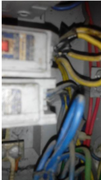
Figura 17. Caja metálica no está debidamente conectada a tierra
