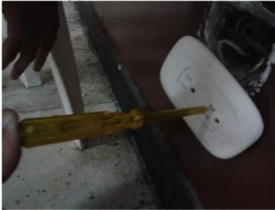
Figura 23. Terminal de fase eléctrica y posicionalmente mal instalado
