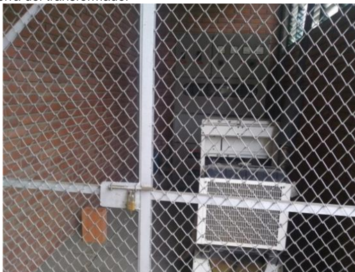
Figura 12. Puesta a tierra del transformador
