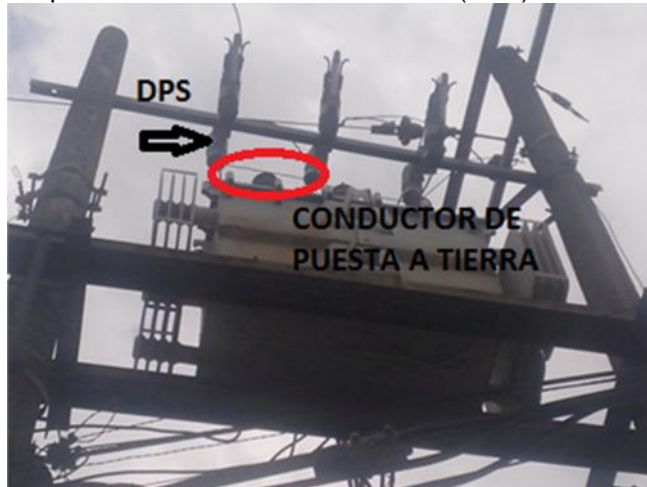
Figura 10. Dispositivo de protección contra sobre tensiones (DPS)
