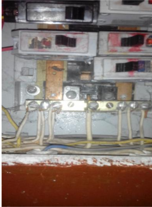
Figura 16. Barraje para conexión del alimentador
