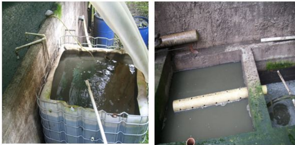
Figura 5: Tanque de dilución y Sedimentador.
