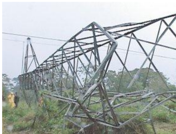
Figura 2. Contingencia provocada por la caída de una torre de una línea de Transmisión.
