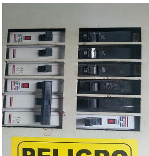
Figura31. Interruptores en perfecto estado
