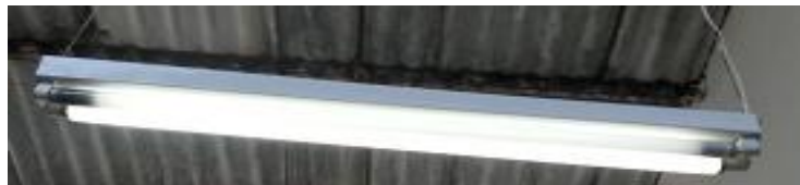
Figura43. Luminaria con tubo dañado
