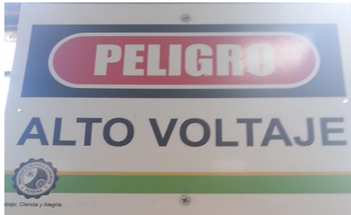
Figura20. Señalización de seguridad
