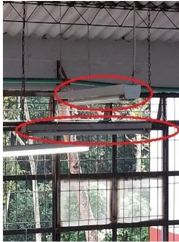
Figura42. Luminaria fuera de servicio
