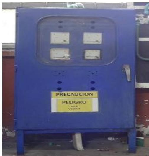
Figura21. Armario eléctrico Taller electricidad
