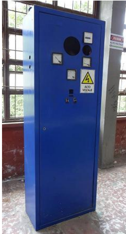
Figura22. Armario eléctrico taller de electricidad
