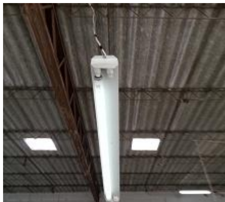
Figura44. Luminaria con ausencia de tubo
