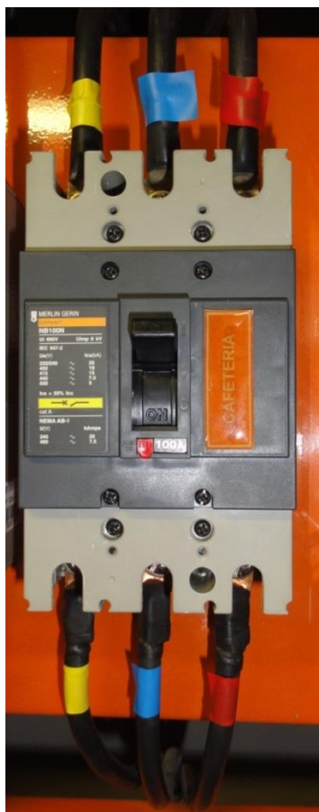
Figura 76. Totalizador de alimentación cafetería
