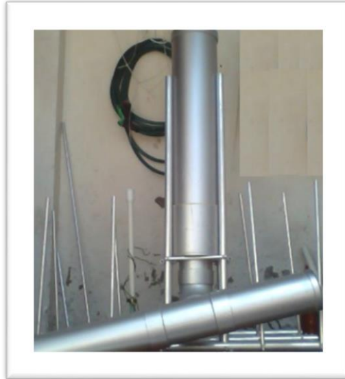
Figura 13. Filtro de arena, grava y carbón
