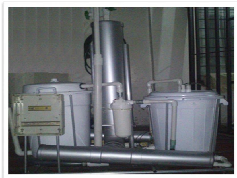
Figura 23. Vista 1 - Sistema reciclaje aguas grises
