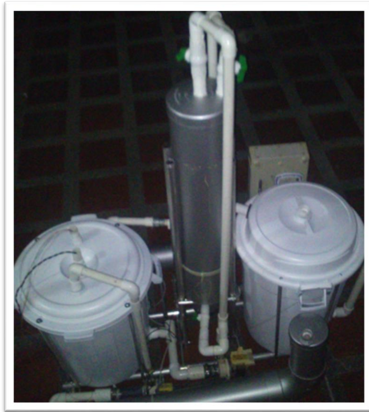
Figura 24. Vista 2 - Sistema reciclaje aguas grises
