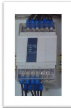
Figura 28. PLC con conexión de entradas y salidas.
