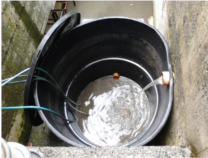
Tratamiento preliminar (tanque de sedimentos).
