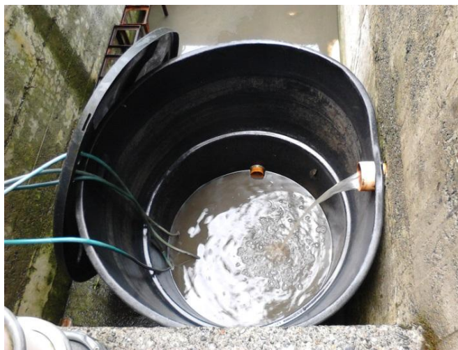
Figura 11. Tanque de Sedimentación. Fuente: Autores
