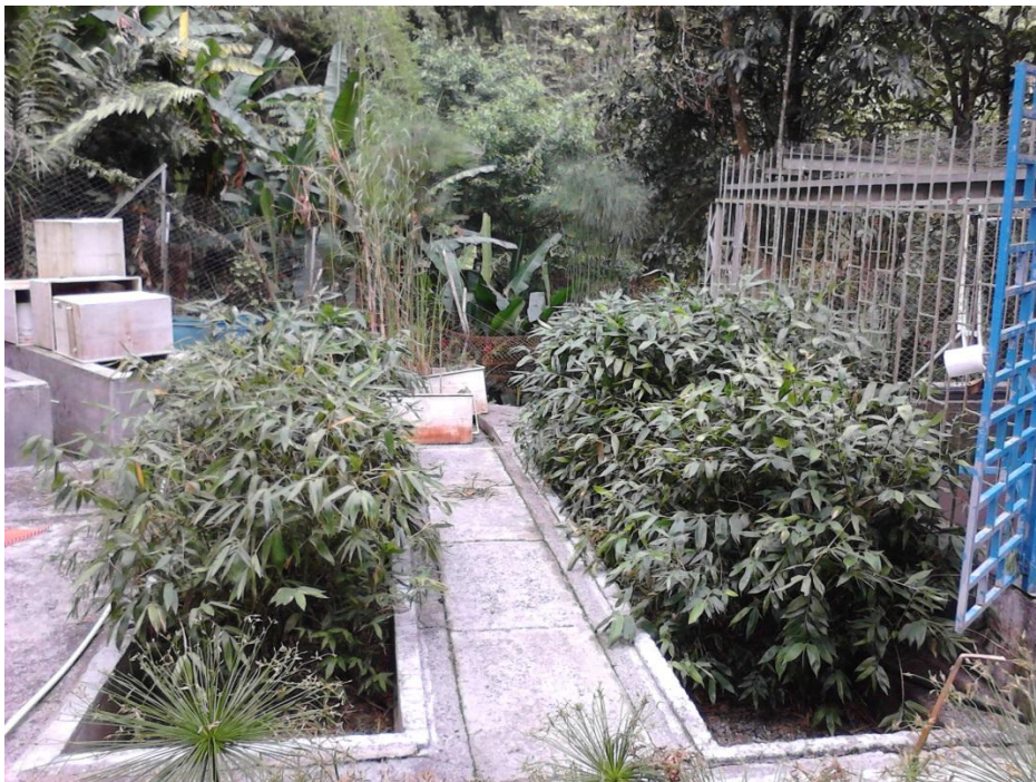
Figura 9. Humedales de flujo subsuperficial. Fuente: Autores
