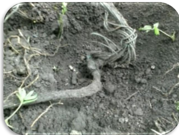
Muestra del recorrido no uniforme, deterioro, lo superficial y los malos empalmes de la malla.
