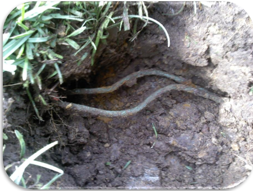
Muestra del estado en que se encuentran los conductores del SPT.
