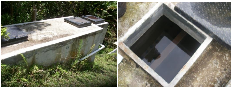
Fotografía 28: Tanque Desarenador, Acueducto Agua Bonita.
