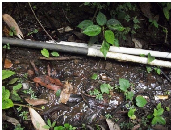
Fotografía 26: Tramos de Reconexión de Tuberías con Diferentes Dimensiones.
