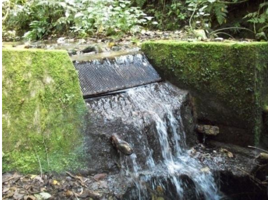
Fotografía 30: Punto de Captación. Acueducto Aguas Maracaibo.
