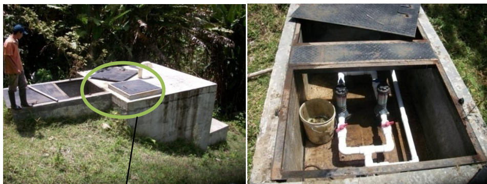
Fotografía 29: Caseta de cloración y tanque de almacenamiento, Acueducto Agua Bonita.
