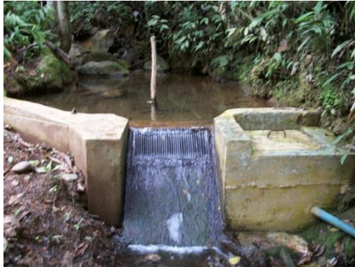
Fotografía 36: Punto de Captación del Acueducto La Cristalina.
