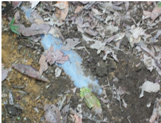
Fotografía 14: Tubería expuesta, Sector La Soledad.
