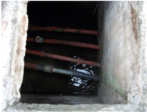
Fotografía 33: Tubos de Conducción de la Caseta de Cloración a las Viviendas. Acueducto Aguas Maracaibo.
