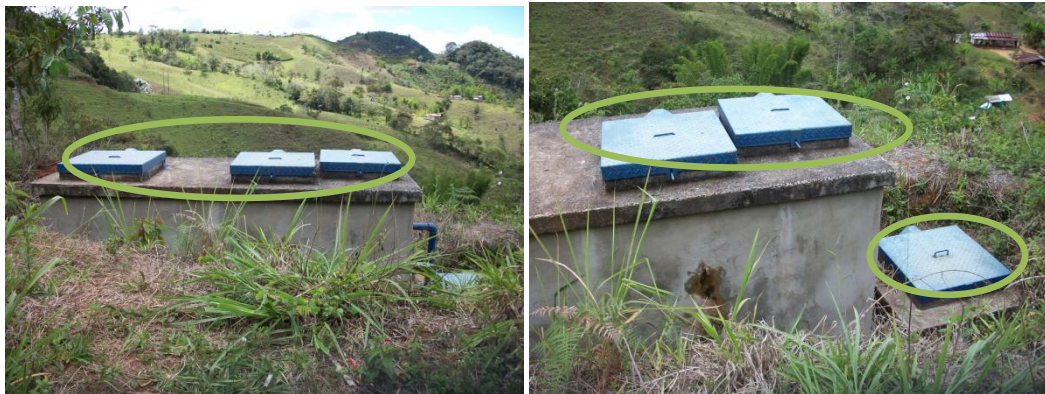
Fotografía 37: Tanque Desarenador Acueducto La Cristalina (año 2012).
