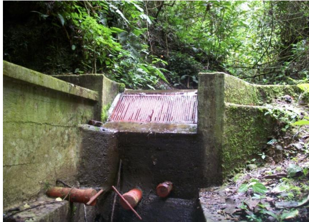
Fotografía 3: Punto de captación, San Roque-Sector Las Brisas.
