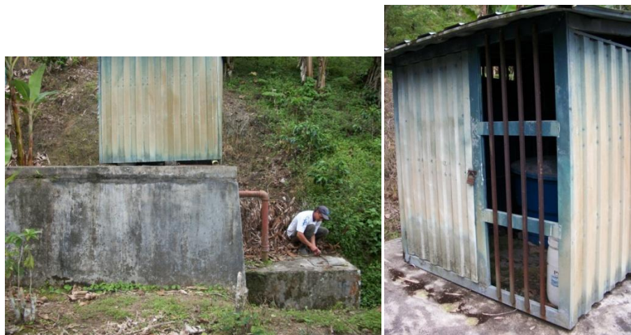
Fotografías 32: Caseta de Cloración. Acueducto Aguas Maracaibo.
