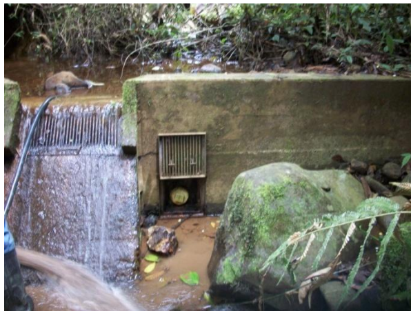
Fotografía 17: Sistema de Captación. Tercera bocatoma, ACUAPALMA.
