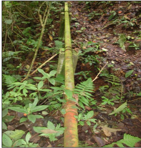
Fotografía 5: Tubería de Conducción en Hierro Galvanizado, San Roque-Sector Las Brisas.
