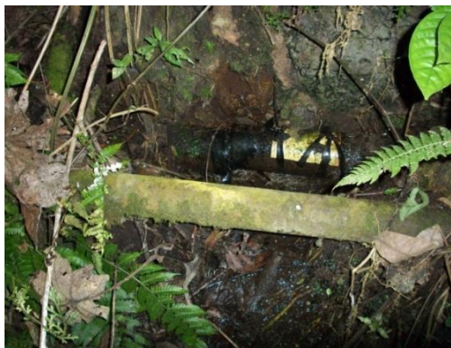
Fotografía 35: Daño en el Tubo de Conducción del Desarenador a la Caseta de Cloración. Acueducto Aguas Maracaibo.
