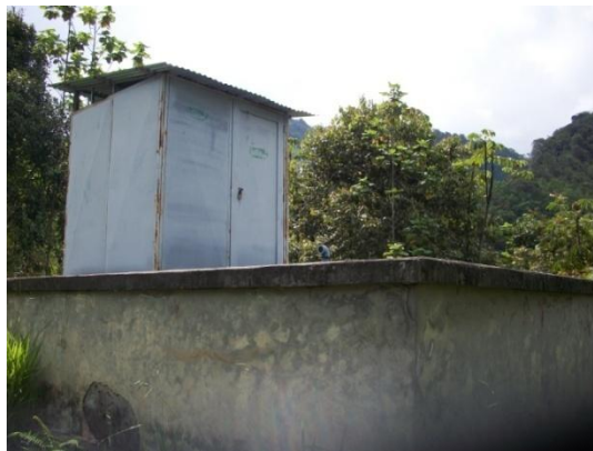
Fotografía 15: Caseta de Cloración, San Roque-La Soledad.
