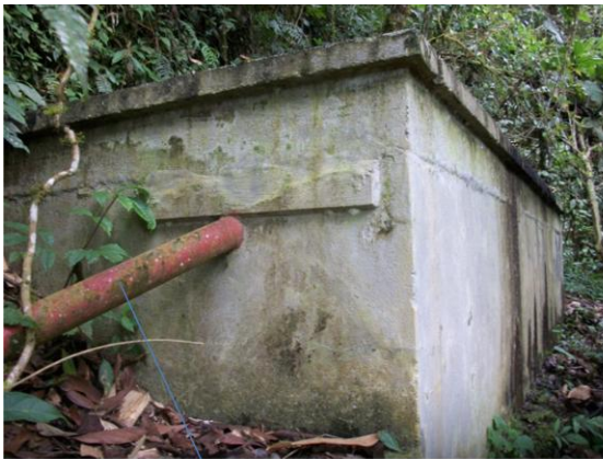
Fotografía 4: Tanque Desarenador, San Roque-Sector Las Brisas.
