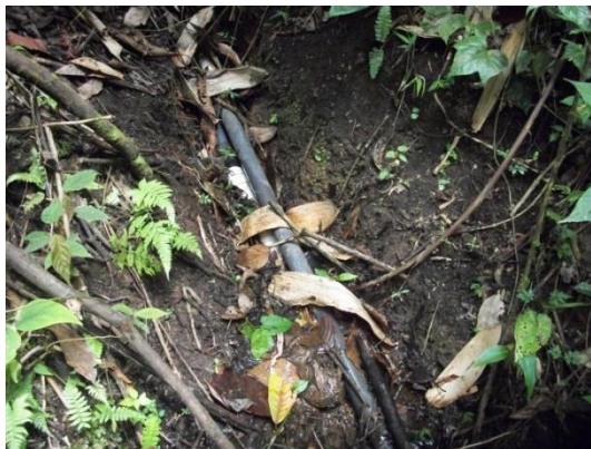
Fotografía 25: Tubería expuesta, ACUAPALMA.
