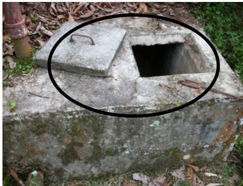
Fotografía 34: Tanque de Almacenamiento. Acueducto Aguas Maracaibo.
