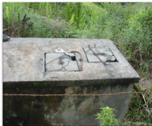
Fotografía 38: Tanque Desarenador Acueducto La Cristalina (año 2006).
