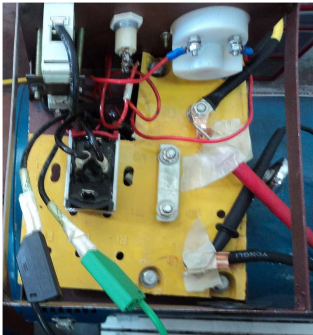
Figura 43. Conexión eléctrica de la excitación
