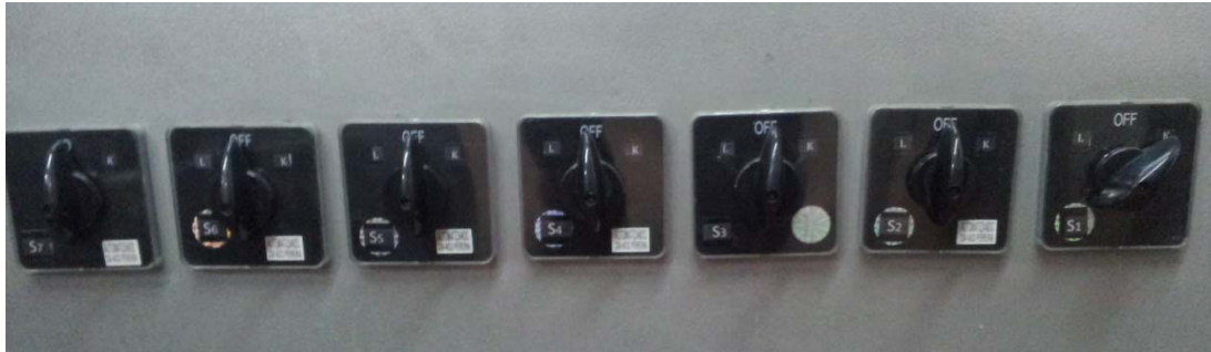
Figura 46. Selectores del banco de resistencias
