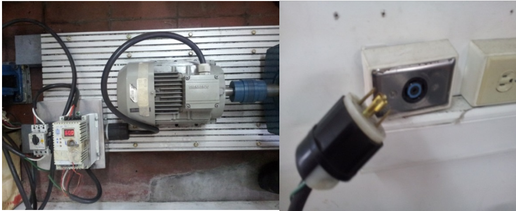
a) Conexión motor-variador
