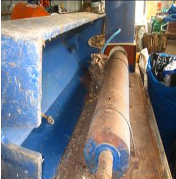
RESIDUOS SÓLIDOS EN EL INTERIOR DEL EQUIPO
