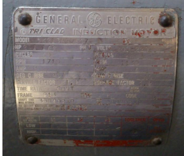
Figura 8. Placa de características del motor de inducción del grupo 4.
