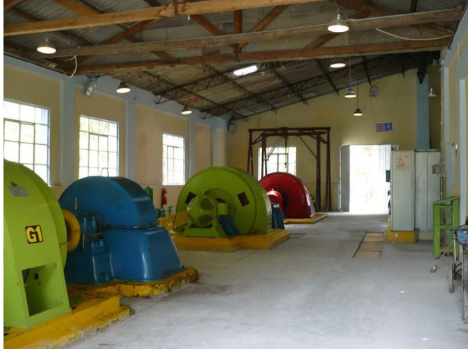
Figura 4. Fotografía Casa de máquinas de la PCH Río Bobo.
