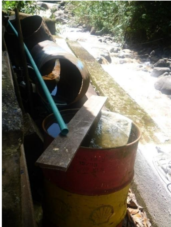
Figura 19. Disposición inadecuada de residuos en PCH Julio Bravo.
