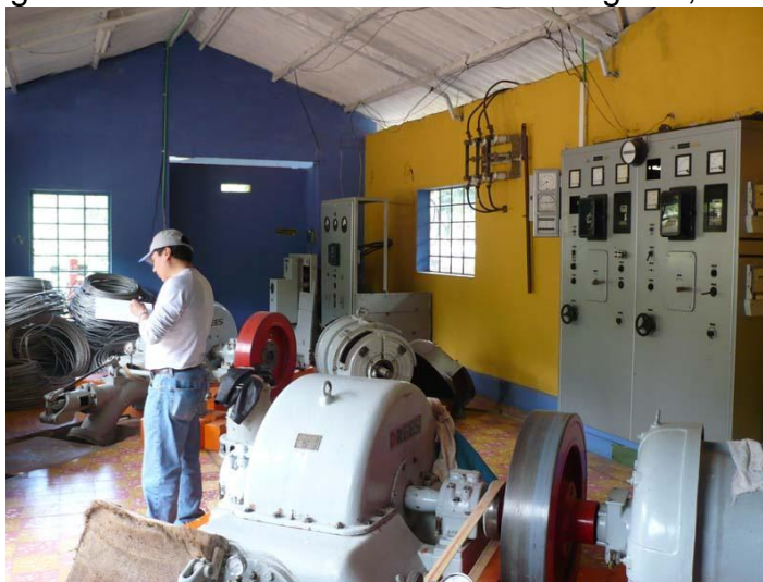
Figura 9. Fotografía Minicentral Hidroeléctrica Río Ingenio, Casa de Máquinas
