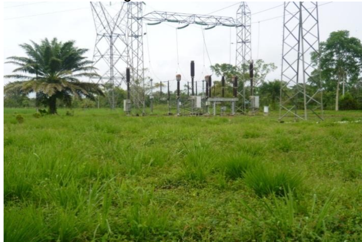
Figura 26. Presencia de vegetación herbácea en Subestación Buchely
