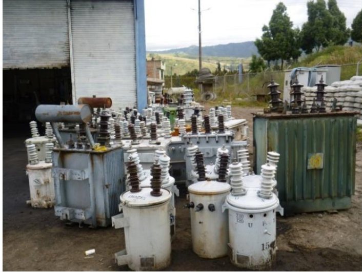
Figura 12. Inadecuada disposición de transformadores.
