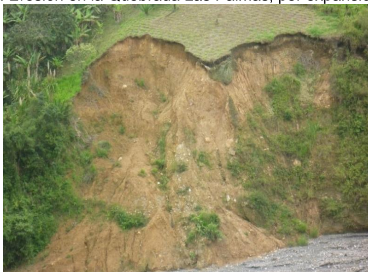
Figura 23. Erosión en la Quebrada Las Palmas, por expansión agrícola
