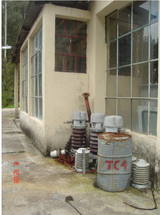
Figura 22 Disposición inadecuada de residuos en PCH Río Sapuyes
