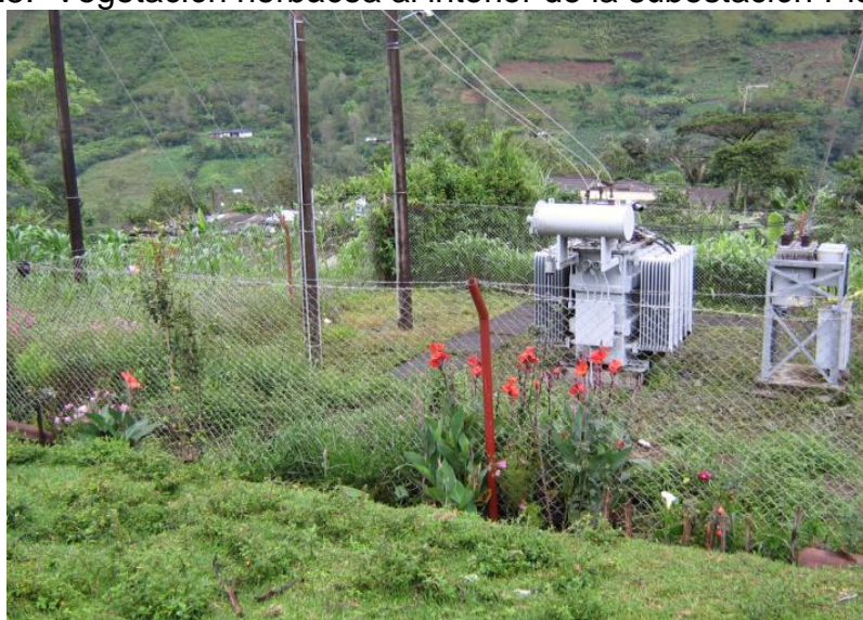
Figura 28. Vegetación herbácea al interior de la subestación Piedrancha
