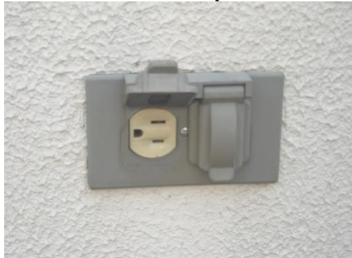
Figura 47. Tomacorrientes exteriores con protección a la intemperie
