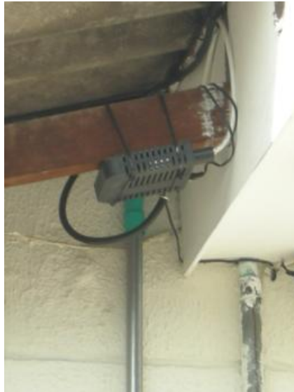
Figura 51. Módem-router inalámbrico ubicado en la entrada
