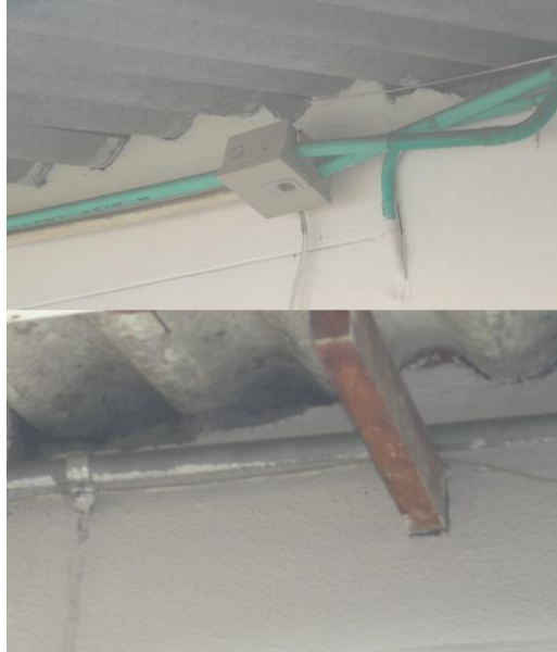
Figura 36. Redes eléctricas en tuberías
