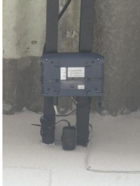
Figura 52. Módem-router inalámbrico ubicado en la pared de la biblioteca
