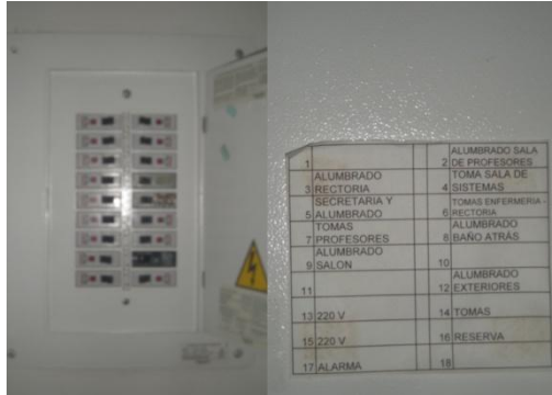
Figura 41. Tablero eléctrico con mala identificación de sus circuitos
