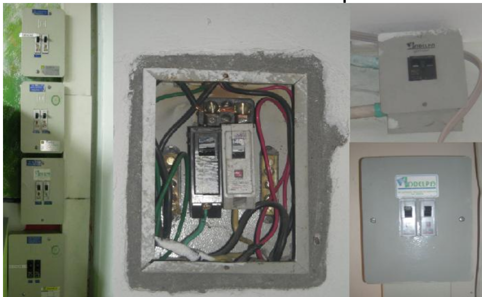
Figura 37. Tableros eléctricos de dos circuitos a disposición
