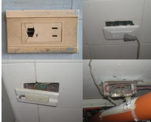
Figura 46. Tomacorrientes en mal estado
