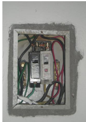
Figura 43. Tablero eléctrico ubicado en la tienda
