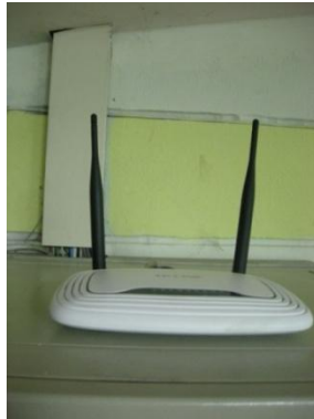
Figura 54. Router inalámbrico sala de sistemas
