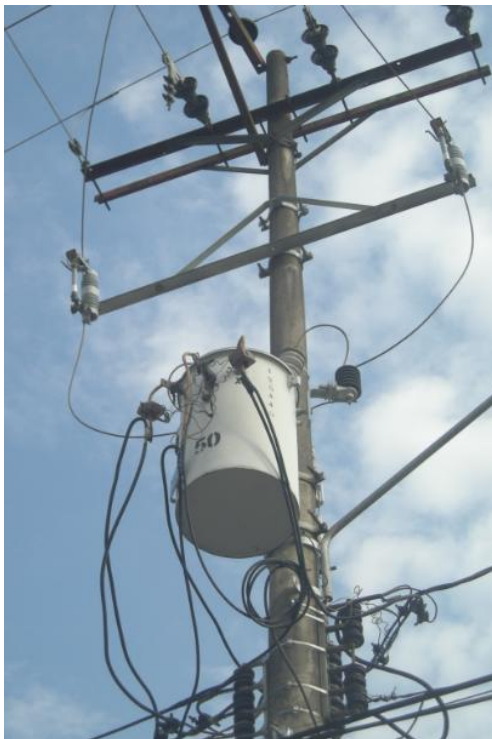
Figura 33. Transformador monofásico 50kVA
