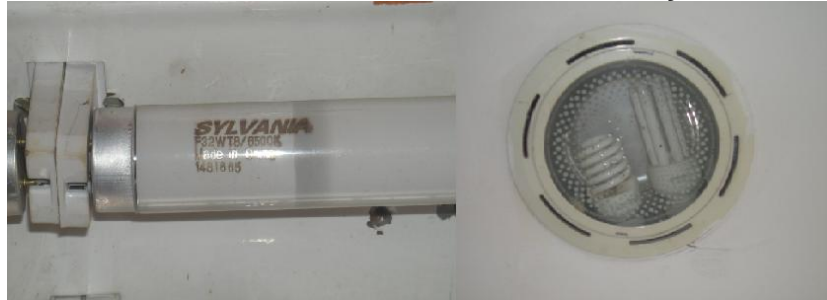
Figura 44. Luminarias usadas en salones, laboratorios y oficinas
