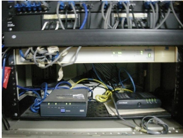
Figura 58. Switch de 12 puertos, módem y router al interior del rack
