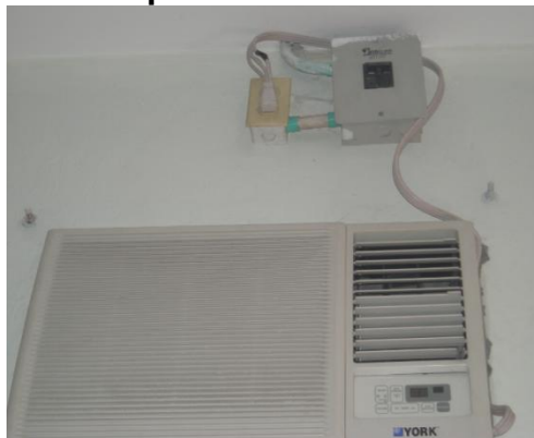
Figura 42. Tablero eléctrico en posición de difícil acceso
