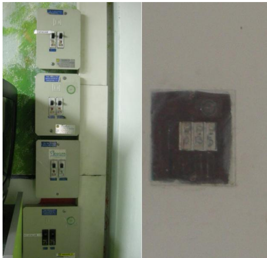
Figura 40. Tableros eléctricos al alcance de los estudiantes
