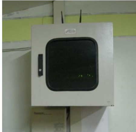
Figura 50. Rack sala de sistemas
