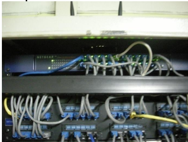
Figura 55. Switch de 24 puertos
