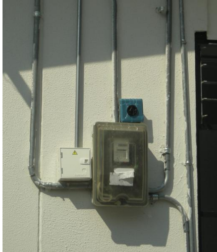
Figura 38. Tableros eléctricos conectados al medidor
