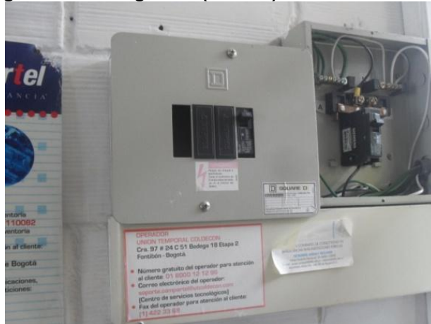
Figura 17. Tablero antiguo circuito regulado (salón 6)
