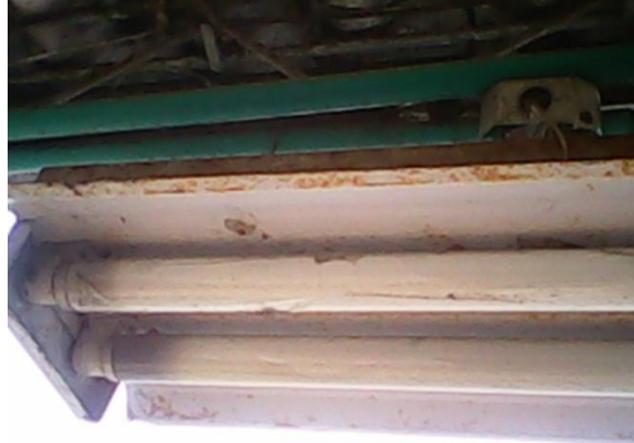
Figura 49. Luminaria fuera de servicio
