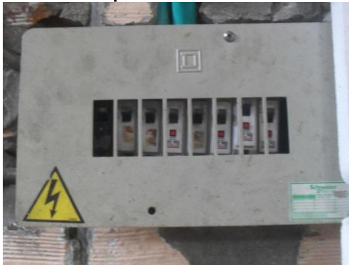
Figura 28. Interruptores debidamente aislados
