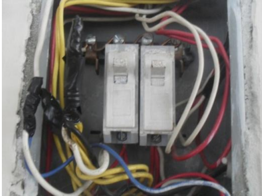
Figura 32. Espacio insuficiente entre conductores
