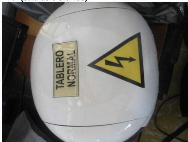
Figura 18. Tablero normal (sala de sistemas)
