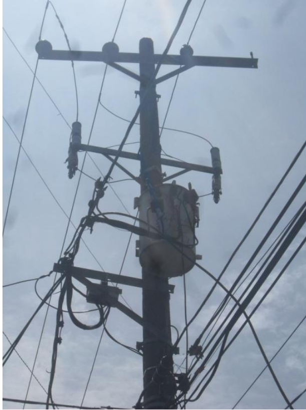
Figura 35. DPS y bujes del transformador.
