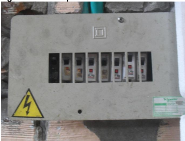
Figura 29. Interruptores en deterioro
