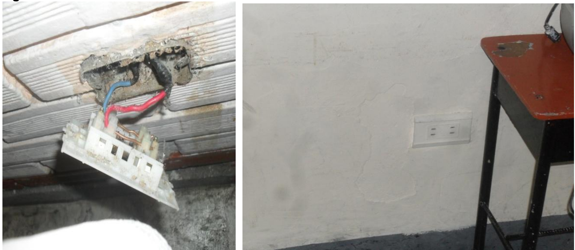
Figura 23. Tomacorriente en mal estado
