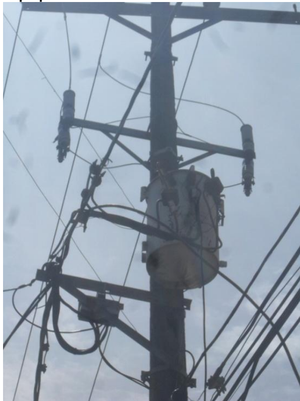
Figura 34. Sub estación tipo poste
