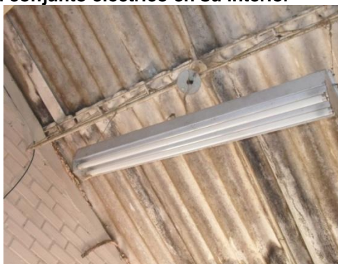
Figura 47. Luminaria con el conjunto eléctrico en su interior
