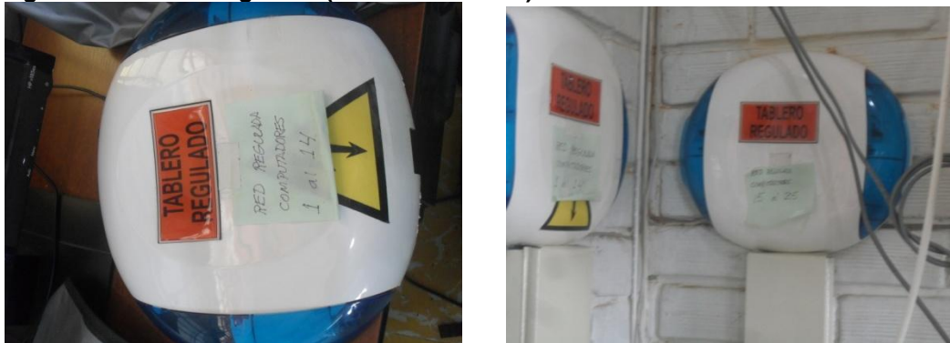
Figura 17. Tablero regulado (sala de sistemas)
