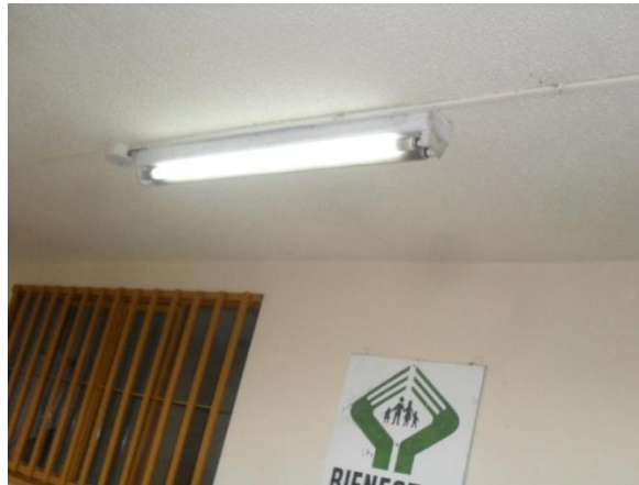
Figura 50. Luminaria con tubo dañado
